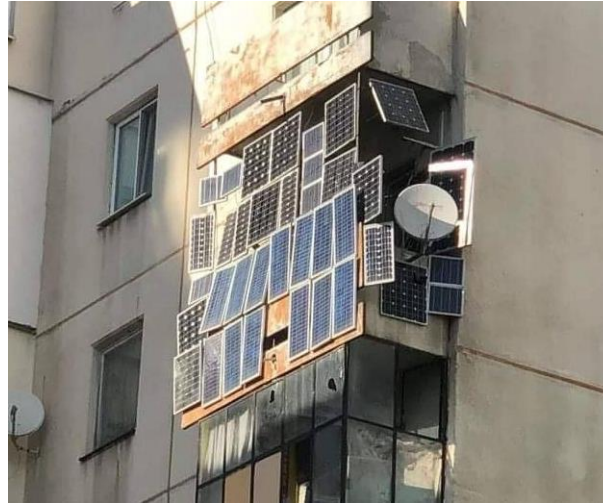
Fig. 4 Esto no es integración fotovoltaica en edificios. Fuente: Internet
