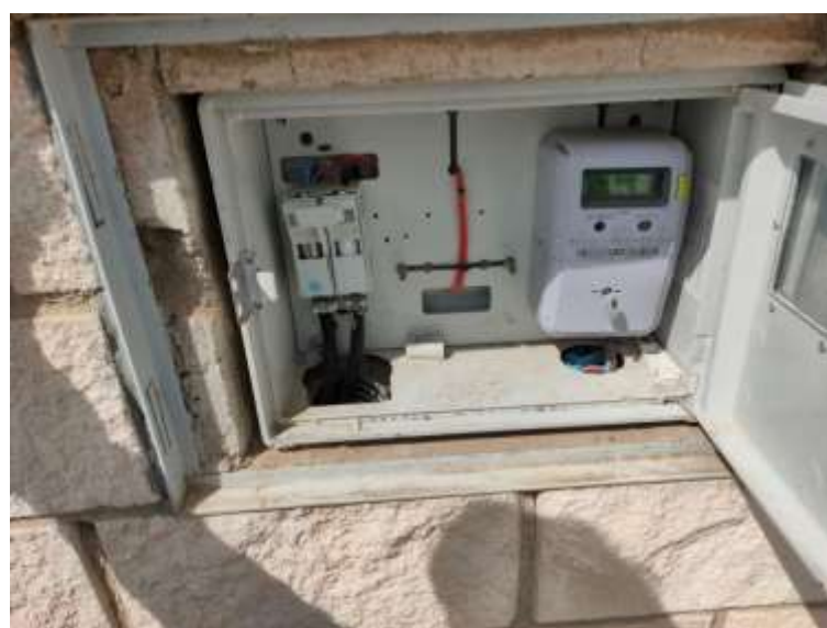
Figura 1.20. Caja general de protección y medida por dentro situada en el exterior de la vivienda
