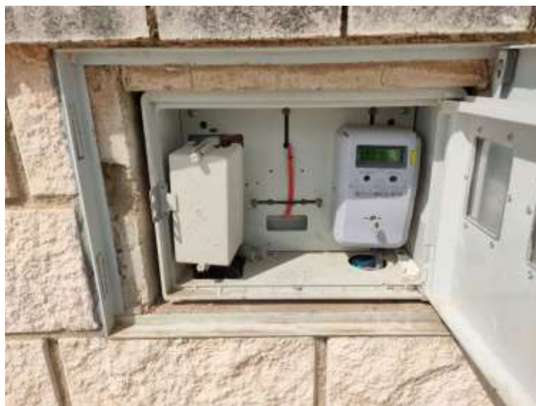
Figura 1.19. Caja general de protección y medida por dentro situada en el exterior de la vivienda
