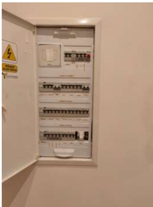
Figura 1.21. Cuadro general de distribución
