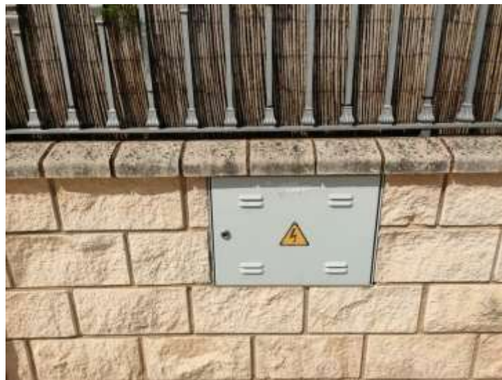
Figura 1.18. Caja general de protección y medida situada en el exterior de la vivienda
