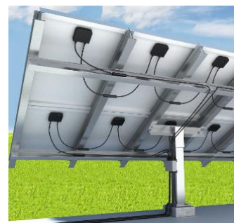
Figura 55.- Cableado generador fotovoltaico.
