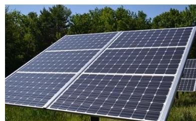
Figura 50.- Generador fotovoltaico tipo.
