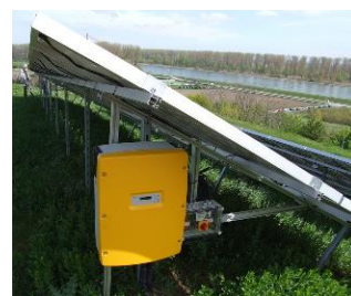
Figura 54.- Inversor en planta fotovoltaica.
