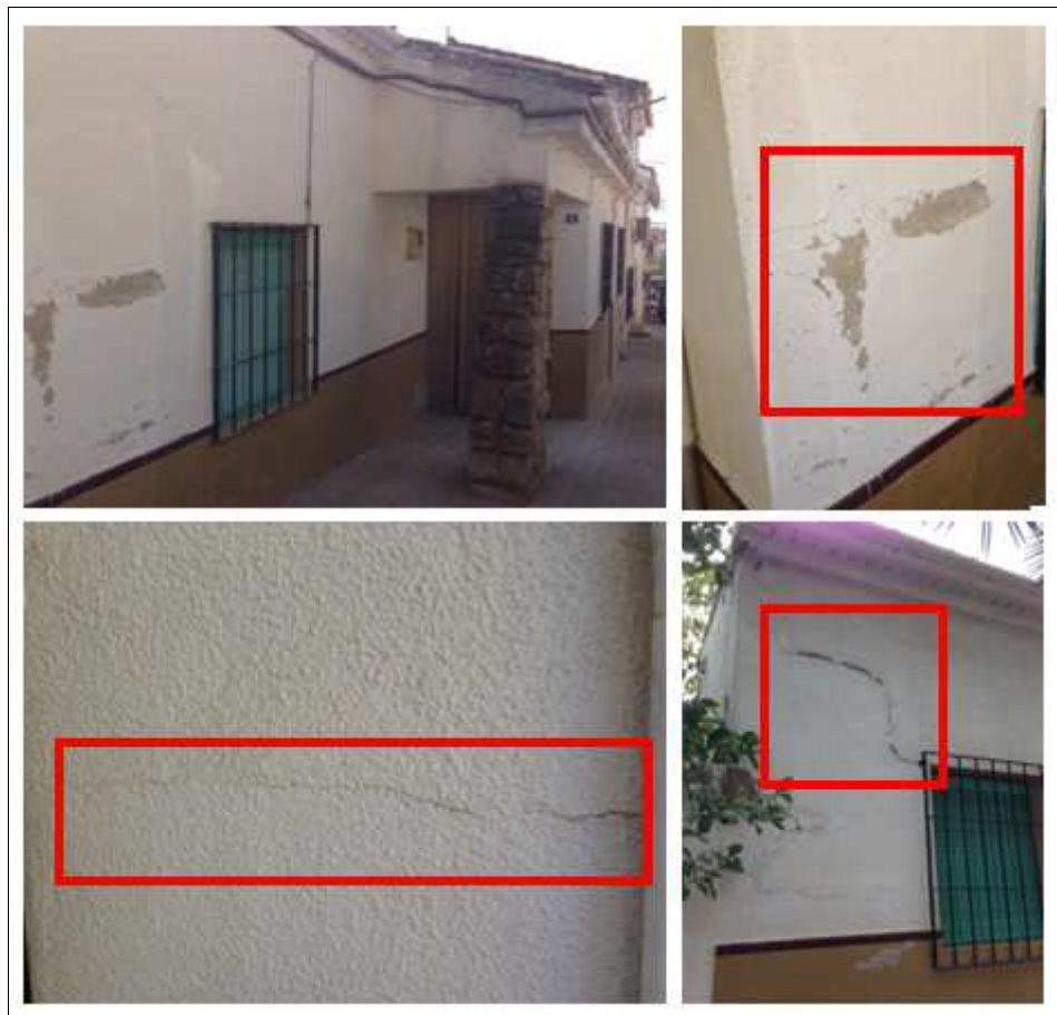
Figura 4.19. Fachada 13 con zoom en zonas deterioradas.
