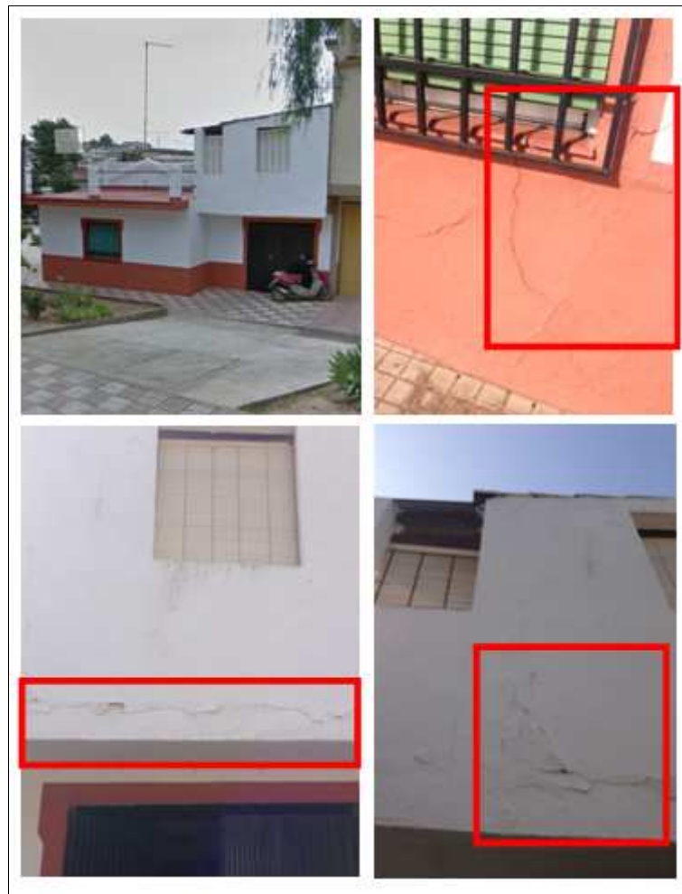
Figura 4.12. Fachada 6 con zoom en zonas deterioradas.
