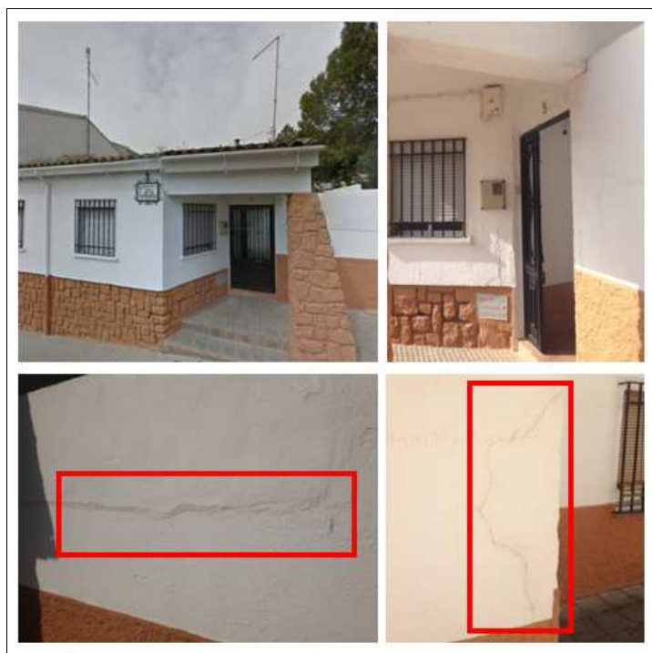
Figura 4.18. Fachada 12 con zoom en zonas deterioradas.
