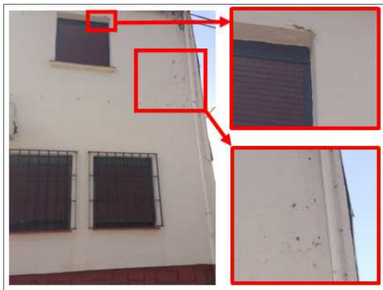
Figura 4.8. Fachada 2 con zoom en zonas deterioradas.
