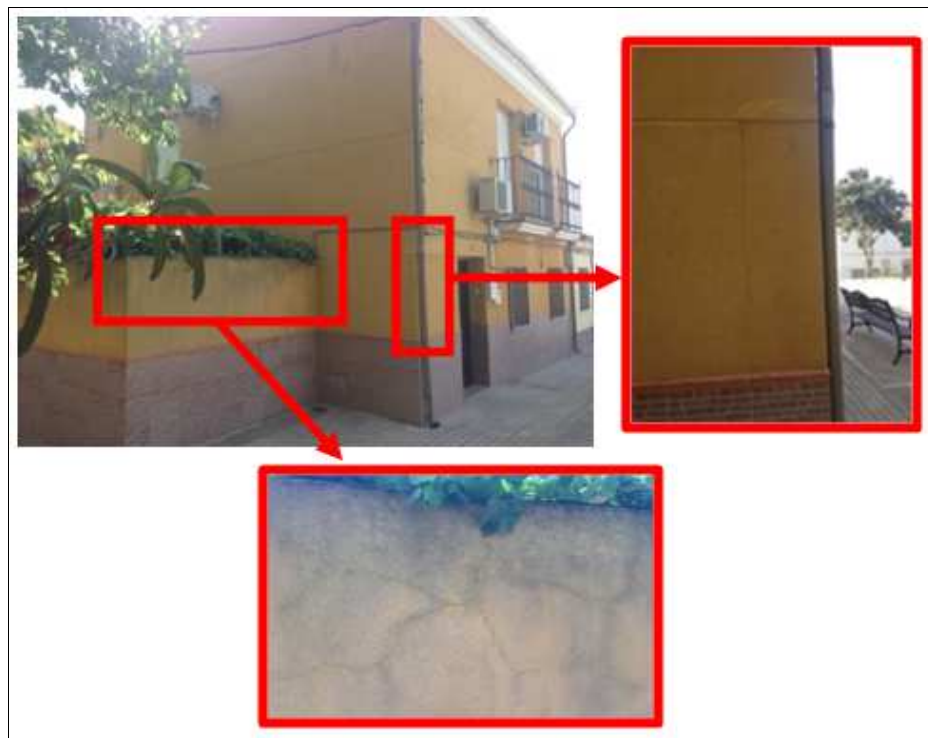
Figura 4.13. Fachada 7 con zoom en zonas deterioradas.
