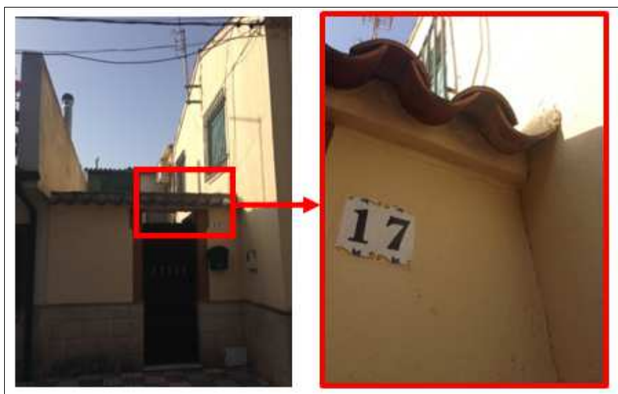
Figura 4.9. Fachada 3 con zoom en zonas deterioradas.
