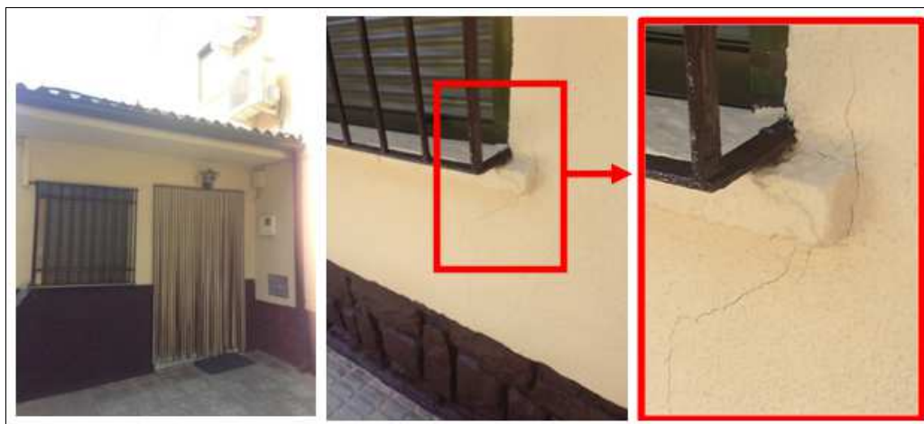
Figura 4.15. Fachada 9 con zoom en zonas deterioradas.
