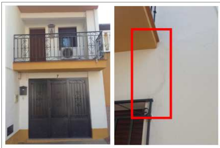
Figura 4.14. Fachada 8 con zoom en zonas deterioradas.
