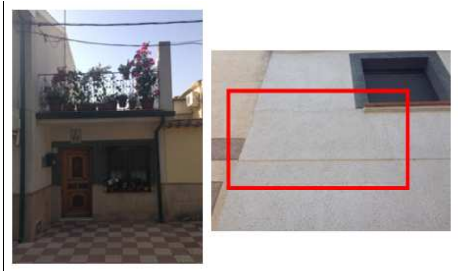
Figura 4.10. Fachada 4 con zoom en zonas deterioradas.
