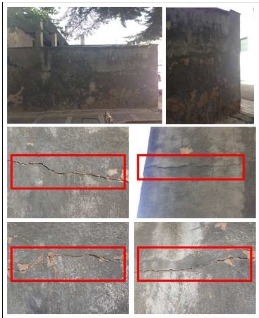
Figura 4.20. Fachada 14 con zoom en zonas deterioradas.
