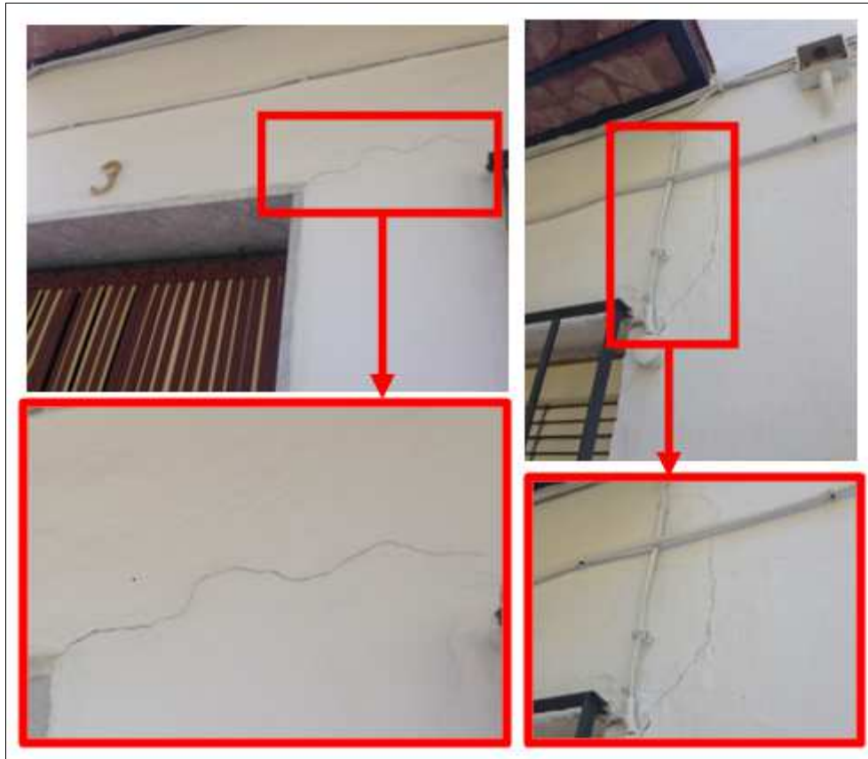
Figura 4.16. Fachada 10 con zoom en zonas deterioradas.
