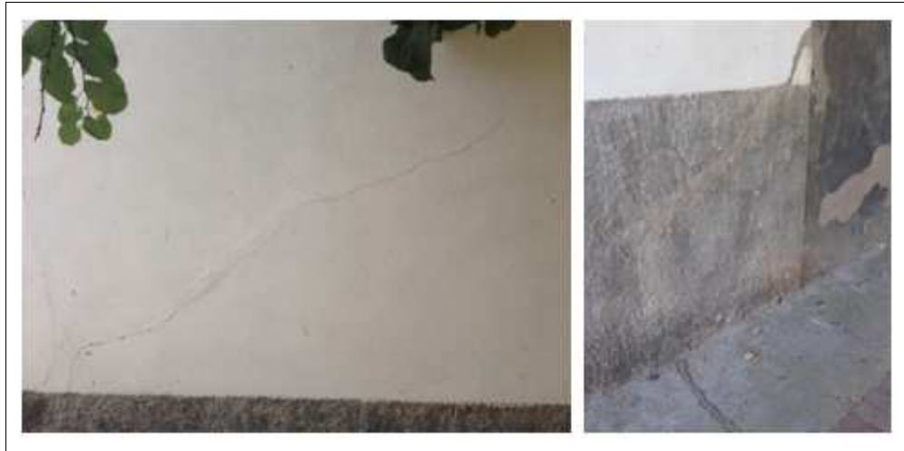
Figura 4.21. Fachada 15 con zoom en zonas deterioradas.
