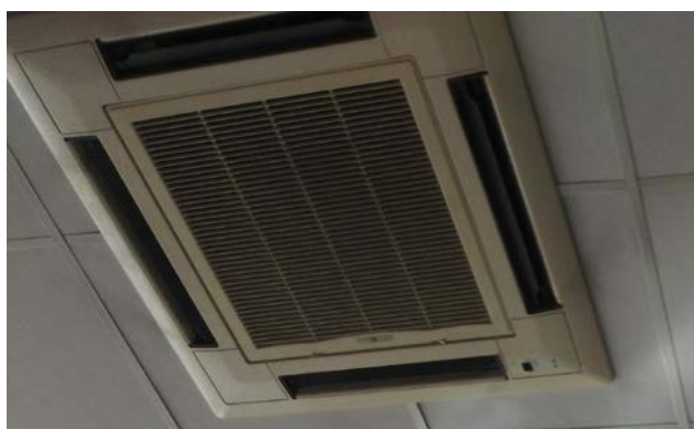
Ilustración 37: Climatización tipo Split (consola de techo).
