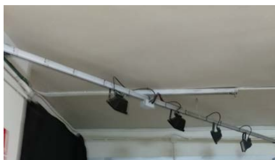
Ilustración 28: Luminarias tipo foco.
