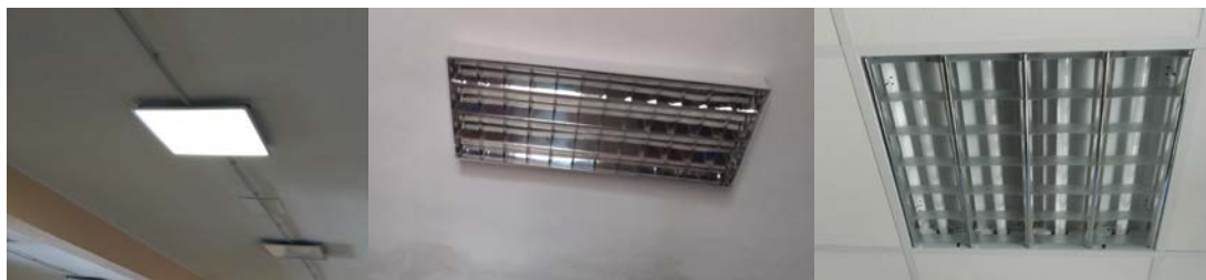
Ilustración 24: Luminarias tipo pantalla. Imagen de la izquierda: tipo led. Imagen de la derecha con lámparas fluorescentes.
