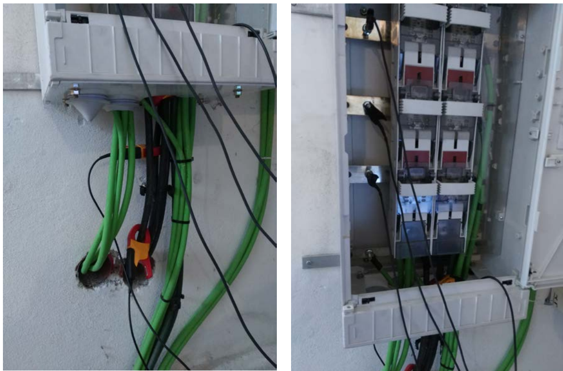
Ilustración 51: Conexiones del cuadro perteneciente al edificio principal.
