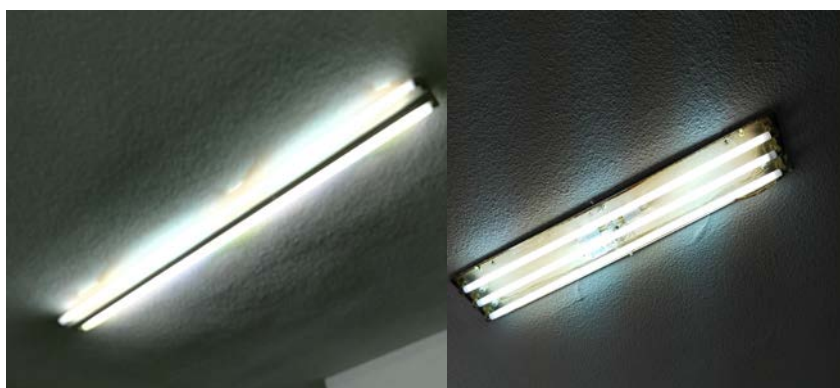
Ilustración 23: Luminarias tipo regleta.
