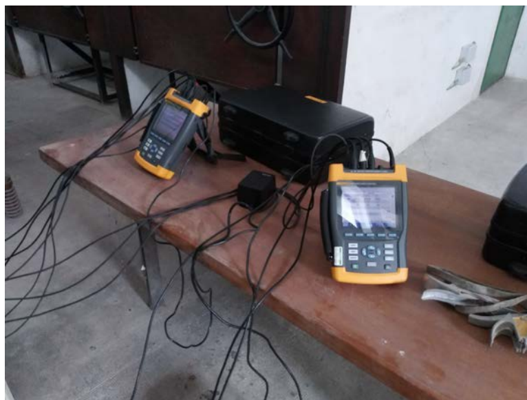
Ilustración 46: Conexiones de los analizadores de redes.
