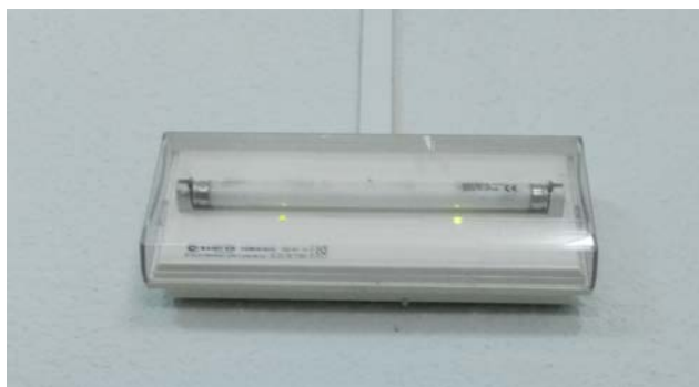
Ilustración 29: Luminarias de emergencia.
