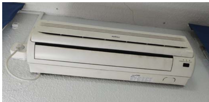
Ilustración 36: Climatización tipo Split (de pared)
