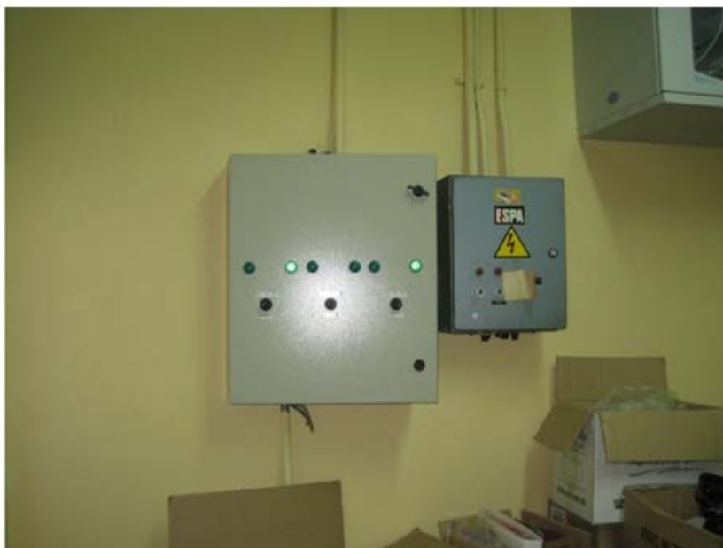
Figura 4.5 Cuadro eléctrico de sala de calderas. [14]
