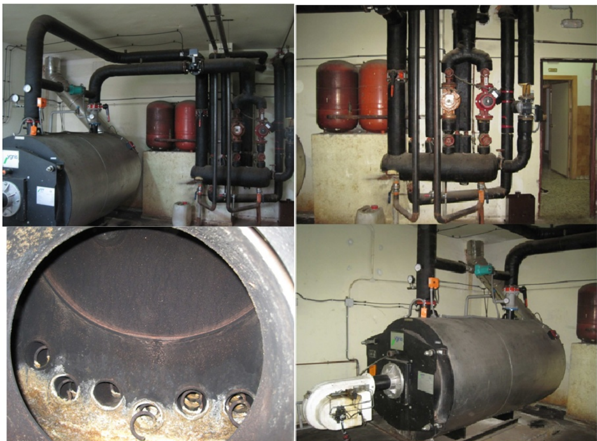
Figura 4.4 Fotografías de detalle de sala de calderas y estado de caldera existente. [14]
