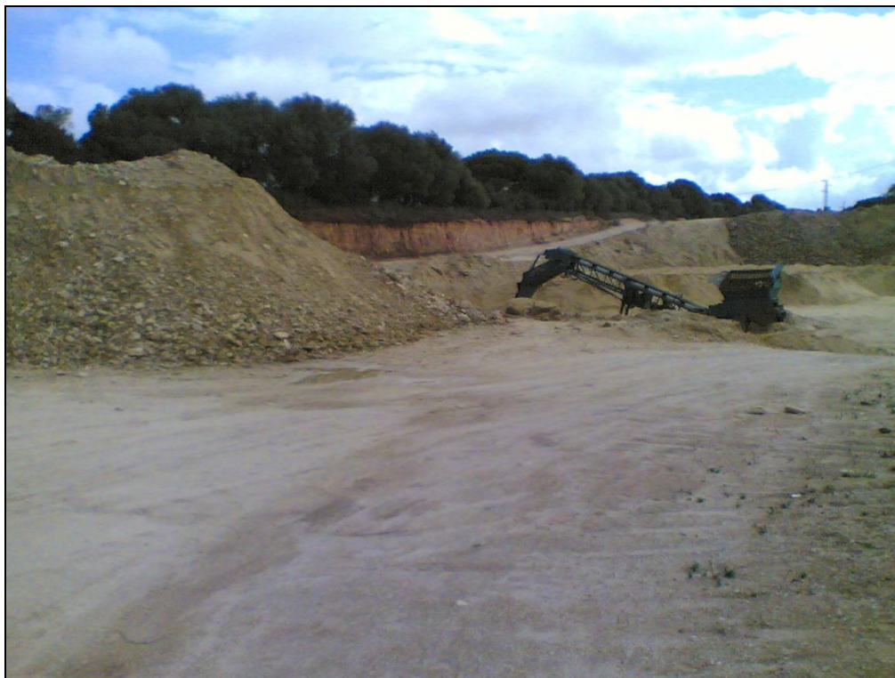
Figura 8.64. Planta de cribado.
