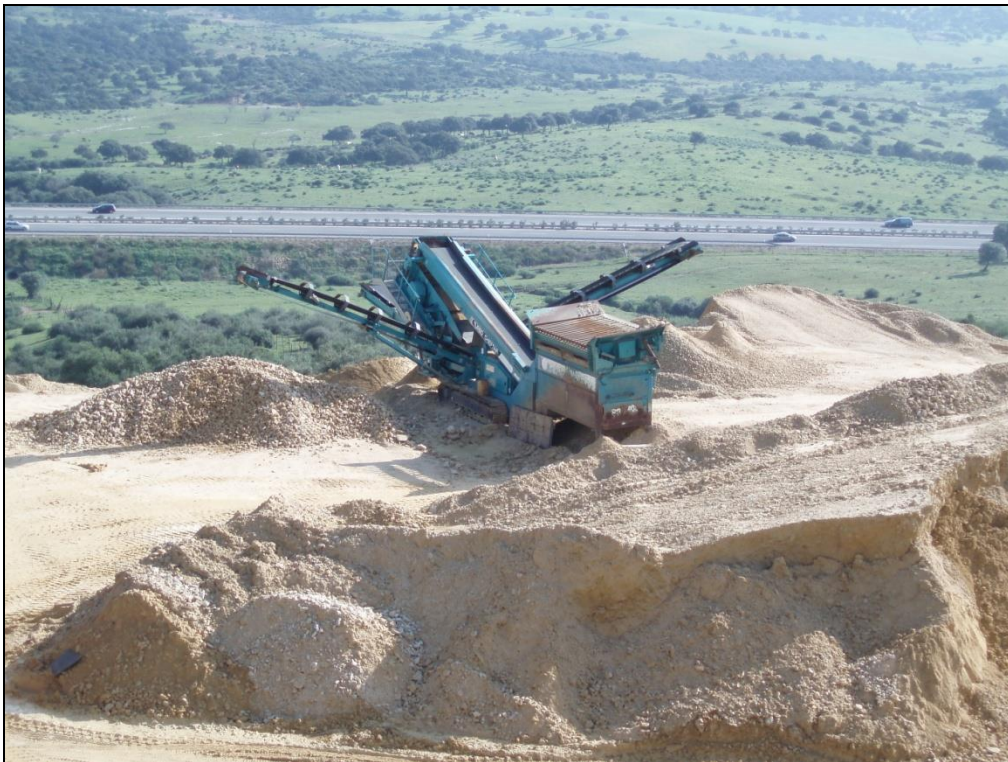
Figura 8.57. Planta de cribado
