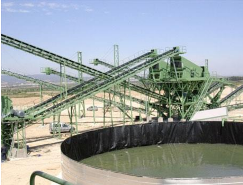
Figura 7.16 Depósito de aguas limpias
