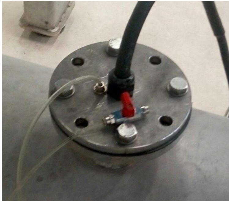
Fotografía 24-Sistema de purga de la bomba.
