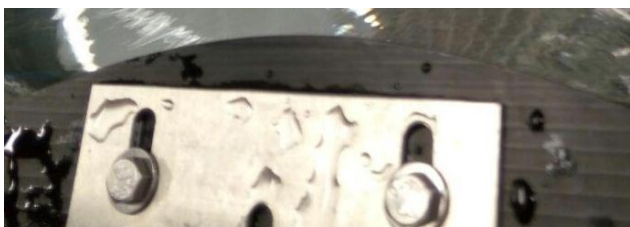
Fotografía 28-Placa metálica usada para fijar el resalto de fondo a la pared del canal.
