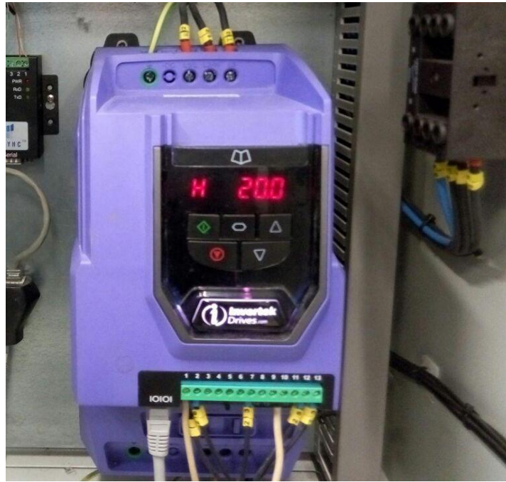
Fotografía 8-Selector de velocidad de la bomba mediante Hz.
