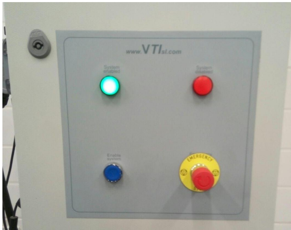
Fotografía 7-Cuadro de control de la bomba.
