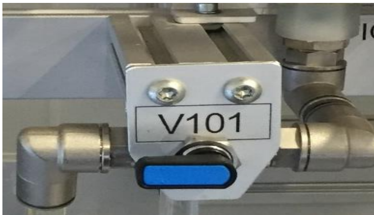
Figura 4.7.10 Válvula manual de tres vías
