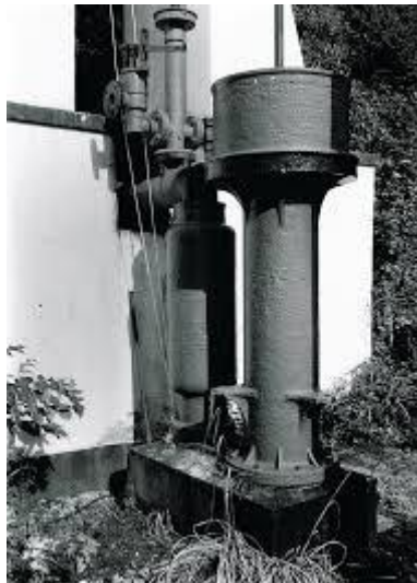
Ilustración 15. Condensador y bomba de aire
