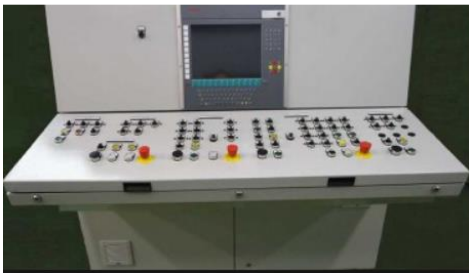
Ilustración 12: cuadro de control
