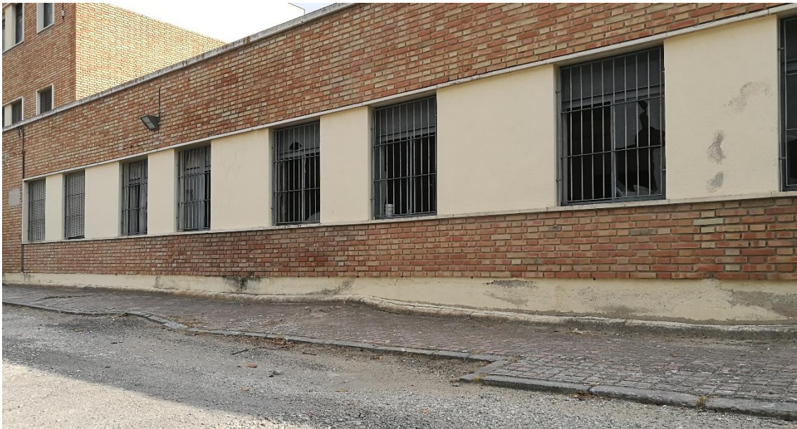
Figura 18. Deformaciones del edificio, visto desde el Noroeste.
