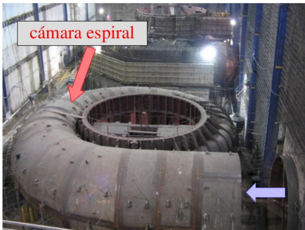
Figura 6.1 Cámara espiral instalada
