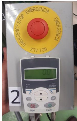
Imagen 29: Controlador del variador.
