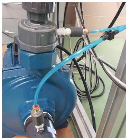
Imagen 43: Sensor de presión instalado
