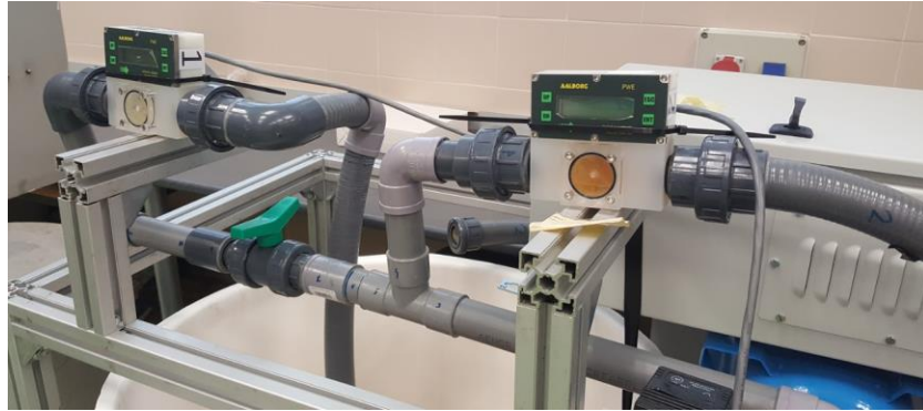
Imagen 46: Sensores de caudal instalados
