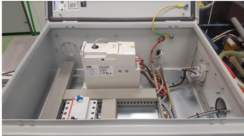
Imagen 28: Variador de frecuencia del puesto
