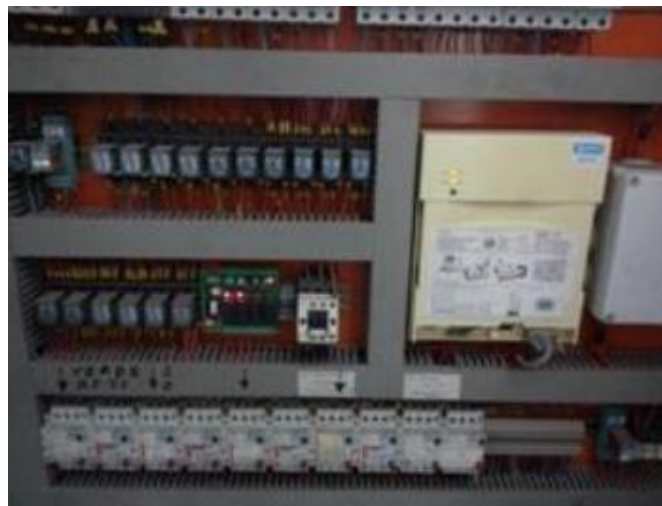
Fig. 8-9: Sistema de control de las calderas
