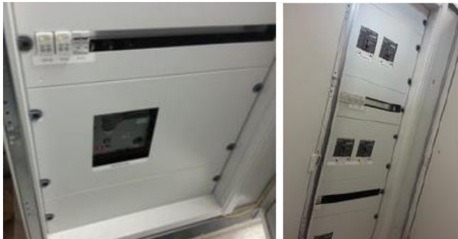
Fig. 7-1: Interruptor general y armario
