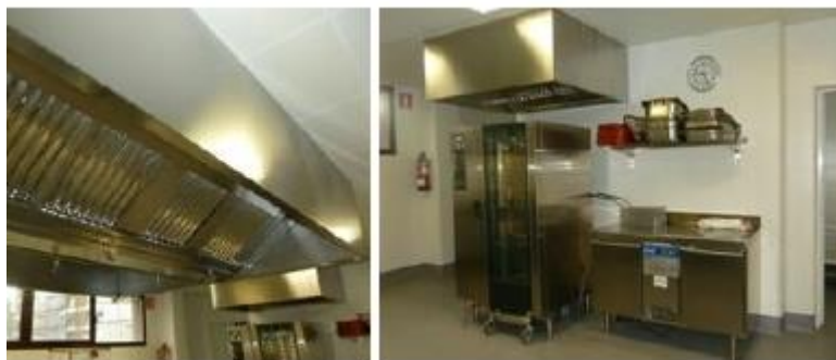
Fig. 8-23: Equipos de cocina
