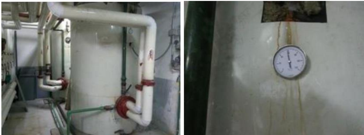
Fig. 8-12: Depósitos de acumulación del A.C.S.
