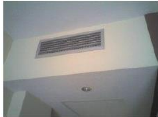
Fig. 8-13: Fan-coil de techo
