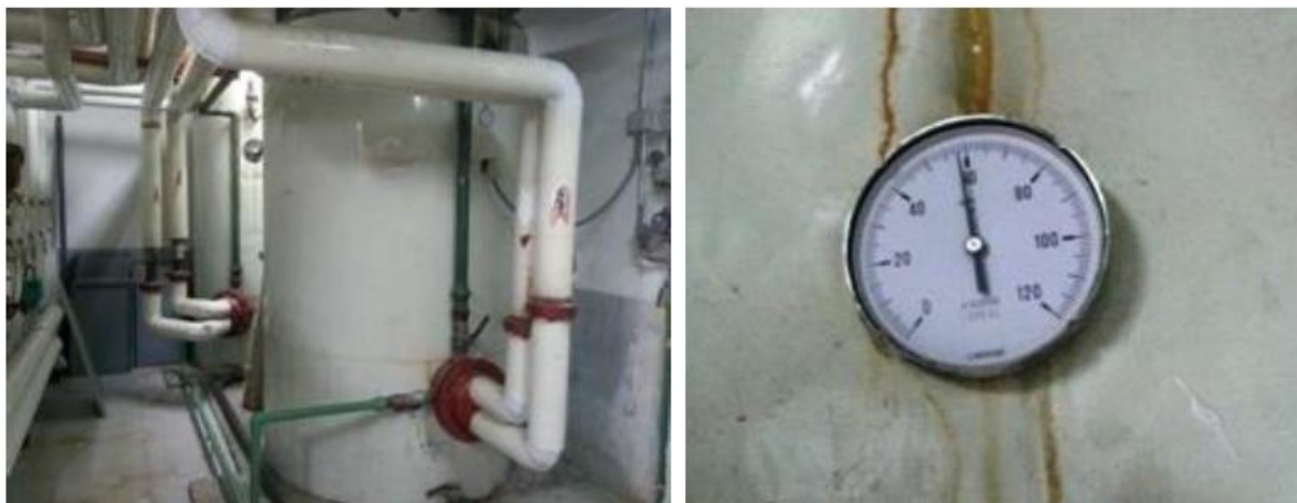
Fig. 8-18: Depósitos acumuladores y termostatos de control de temperatura
