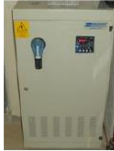
Fig. 7-2: Batería de condensadores
