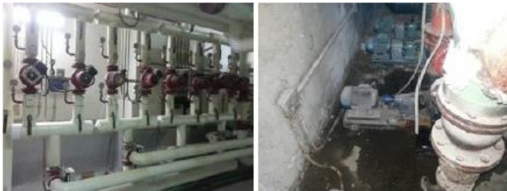
Fig. 8-11: Bombas de impulsión del circuito de calefacción
