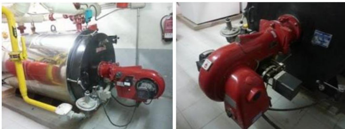
Fig. 8-8: Caldera gasóleo y quemador
