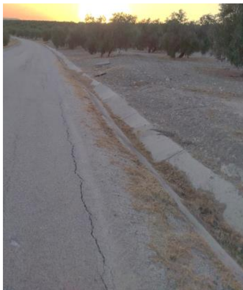
Figura 8: Grieta en comienzo de badén
