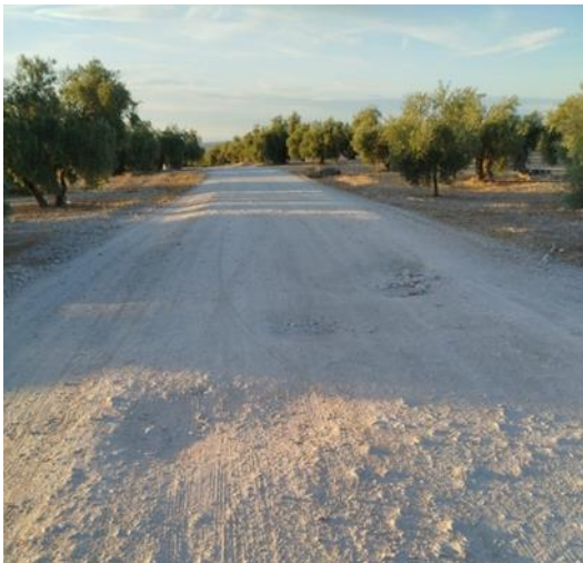
Figura 13: Firme en mal estado
