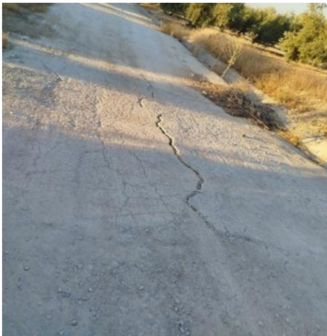
Figura 17: Firme en mal estado
