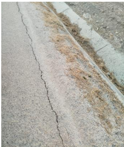
Figura 7: Grieta en comienzo de badén
