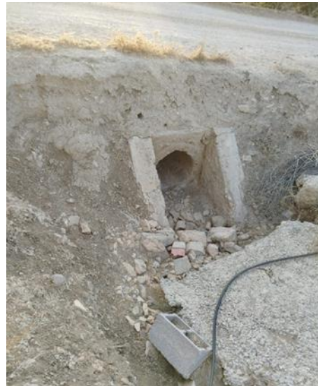
Figura 34: Drenajes en mal estado
