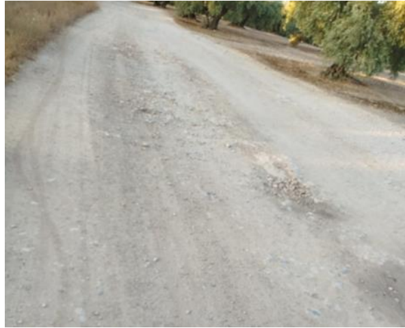
Figura 16: Firme en mal estado
