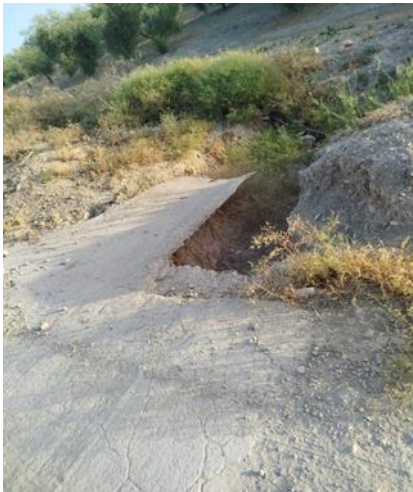
Figura 27: Drenaje en mal estado
