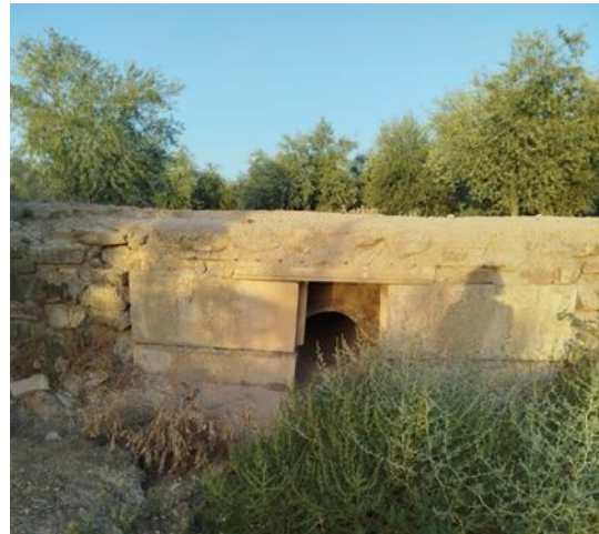
Figura 32: Drenajes en mal estado
