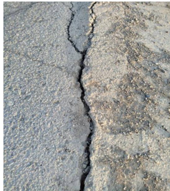
Figura 24: Firme en mal estado
