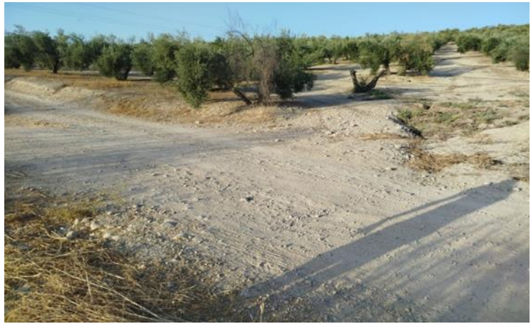
Figura 26: Zona inundada de barro, necesidad de drenaje
