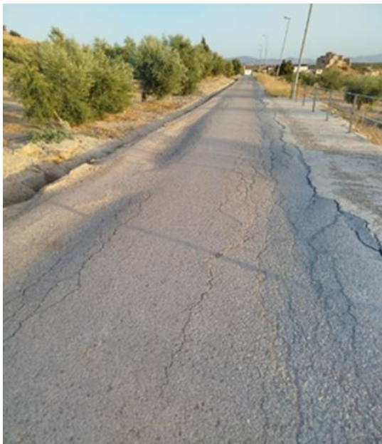
Figura 23: Firme en mal estado
