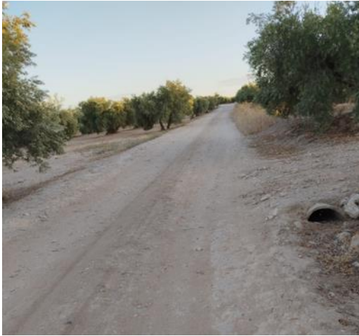
Figura 15: Drenaje casi cejado por barro
