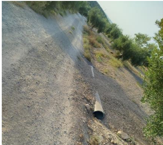
Figura 28: Drenaje en mal estado
