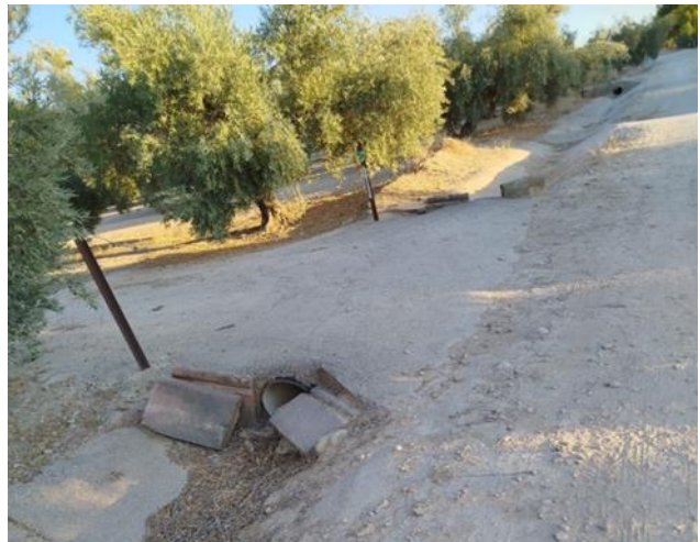
Figura 18: Drenaje mal ejecutado
