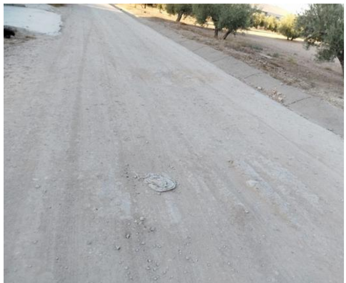
Figura 20: Firme en mal estado
