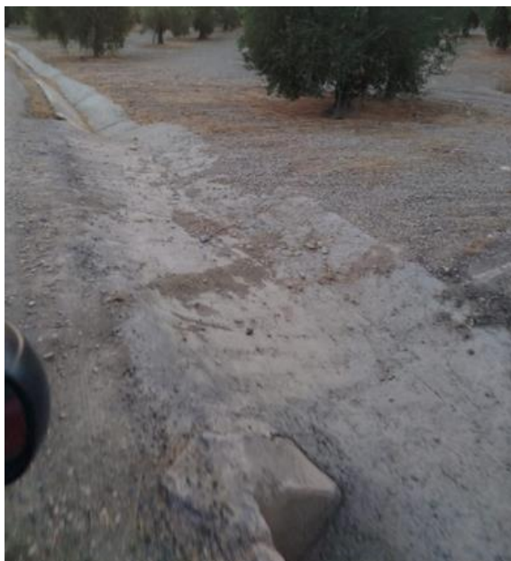
Figura 9: Drenaje mal construido
