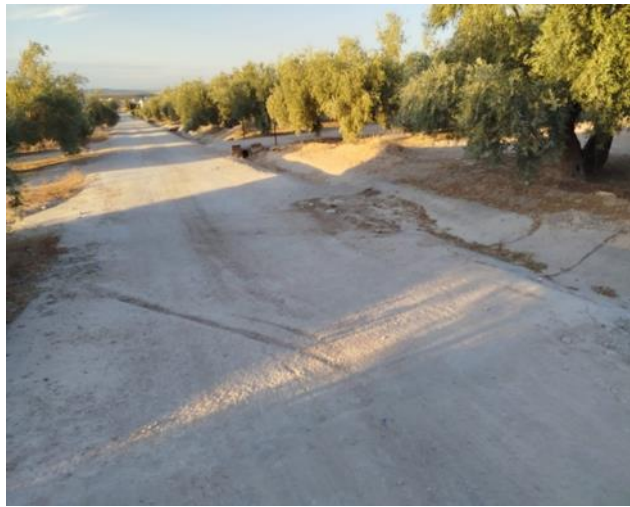
Figura 14: Cuneta llena de barro
