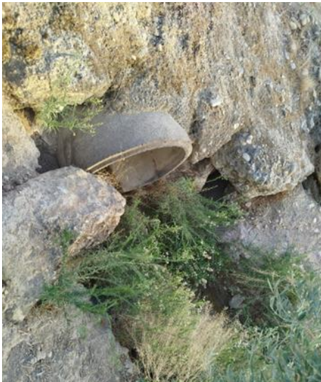
Figura 33: Drenajes en mal estado
