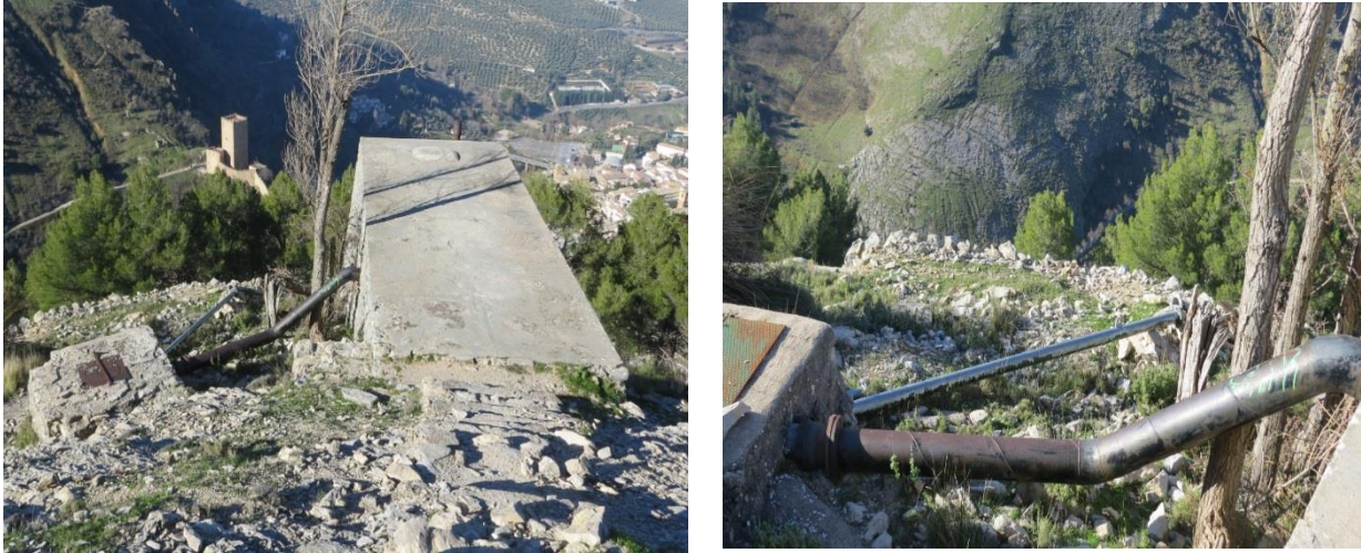
Figura 6. Cámara de carga
