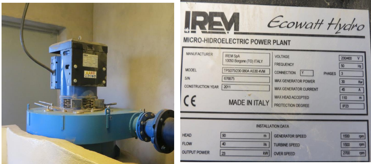
Figura 12. Generador síncrono trifásico
