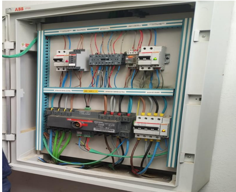
Figura 13. Cuadro eléctrico del punto de consumo
