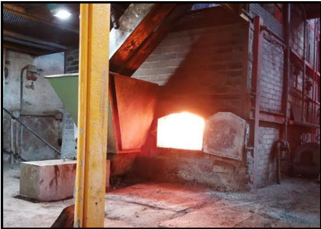
Figura 2.4 Sala de caldera
