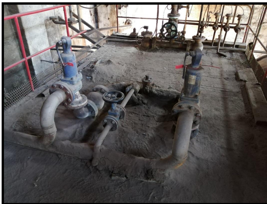
Figura 2.9 Válvulas de seguridad de la caldera actual.
