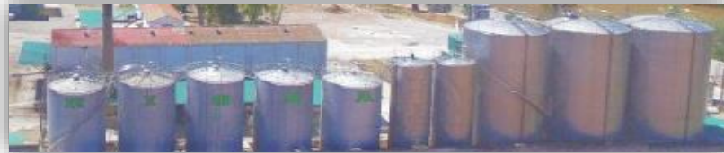
Figura 1.1 Depósitos de almacenamiento de la empresa RIOSA, zona 1.
