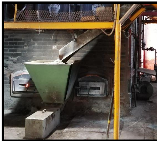
Figura 2.12 Tolva de recepción de combustible.
