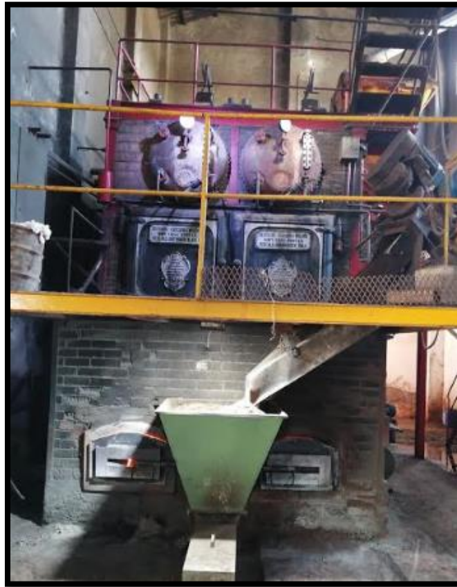
Figura 2.6 Imagen frontal de la caldera actual
