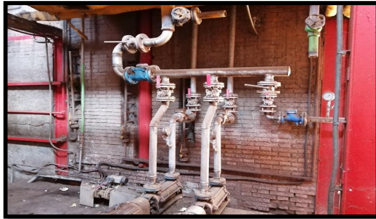
Figura 2.8 Válvulas reguladoras de la caldera actual.
