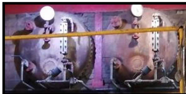
Figura 2.10 Indicadores de nivel de la caldera actual.
