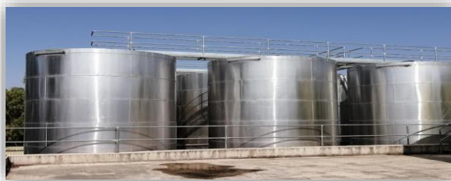
Figura 1.2 Depósitos aislados térmicamente, zona 2.
