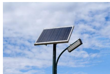
ILUSTRACIÓN 4 PANEL SOLAR FIJO
