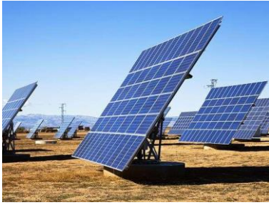
ILUSTRACIÓN 5 SISTEMA CON MOVIMIENTO 1 EJE
