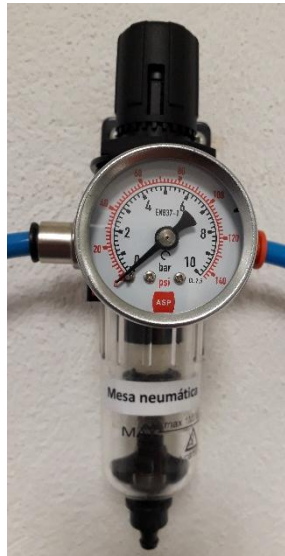
Ilustración 3.1 Manómetro/purgador de la instalación (autor)
