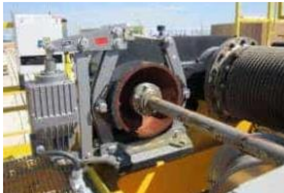
Imagen 3.3: Freno para puente grúa.
