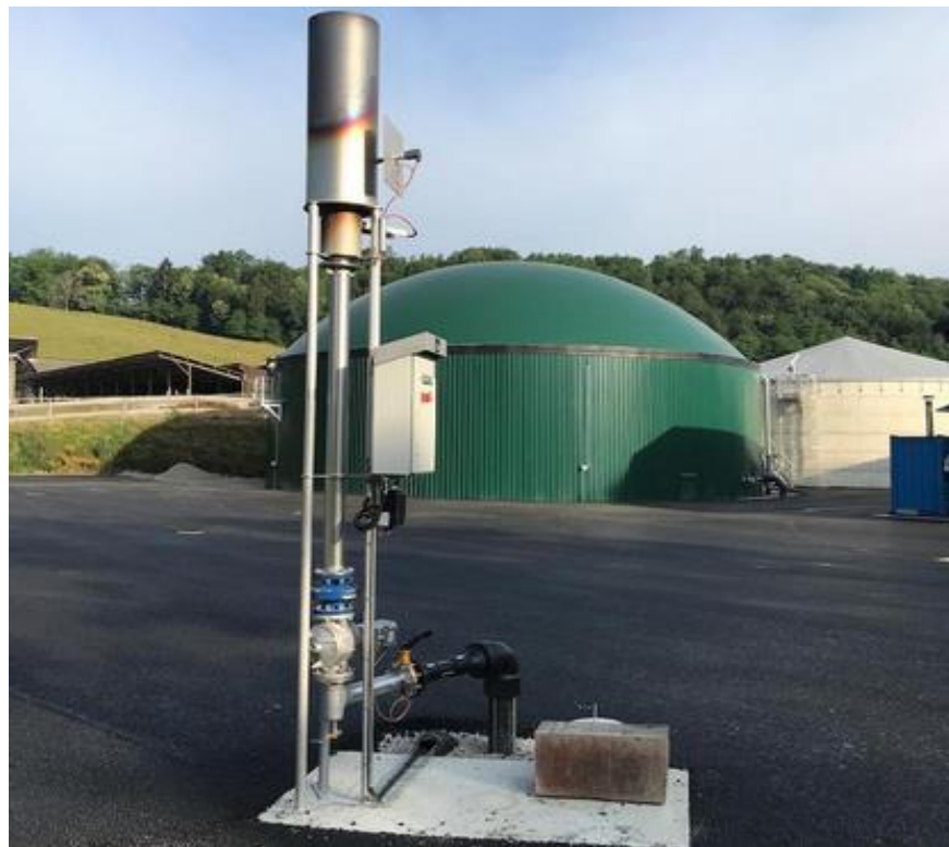
Figura 71. Antorcha en una planta de biogás. Fuente [85]
