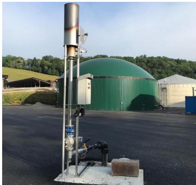
Figura 54. Antorcha en una planta de biogás. Fuente: [67]
