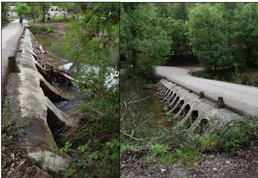
Figura 5. aspectos de los canales de drenaje transversal del vado (04/05/2022)
