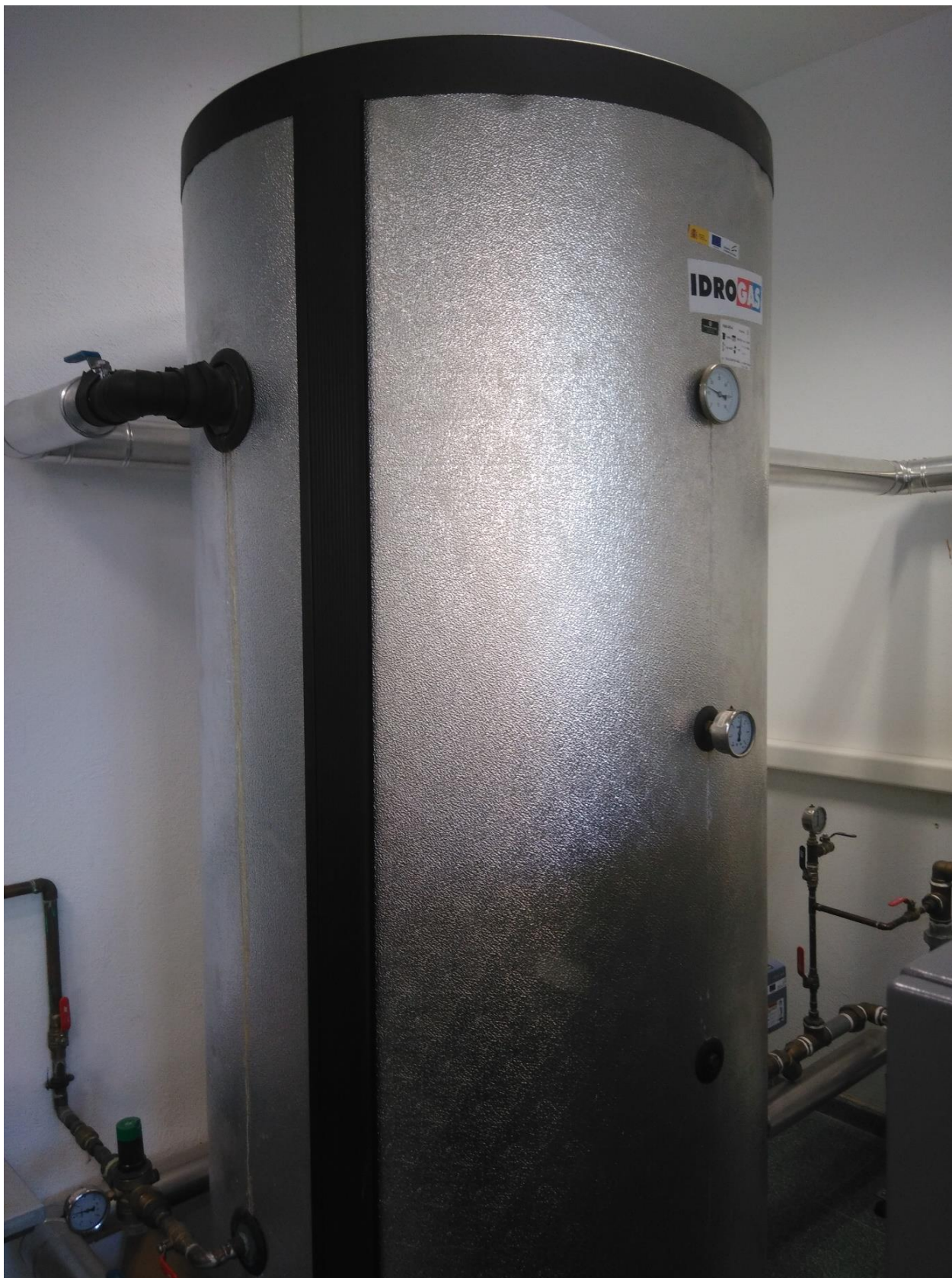
Figura 3.5. Depósito de agua que refrigera el aceite a través del equipo
