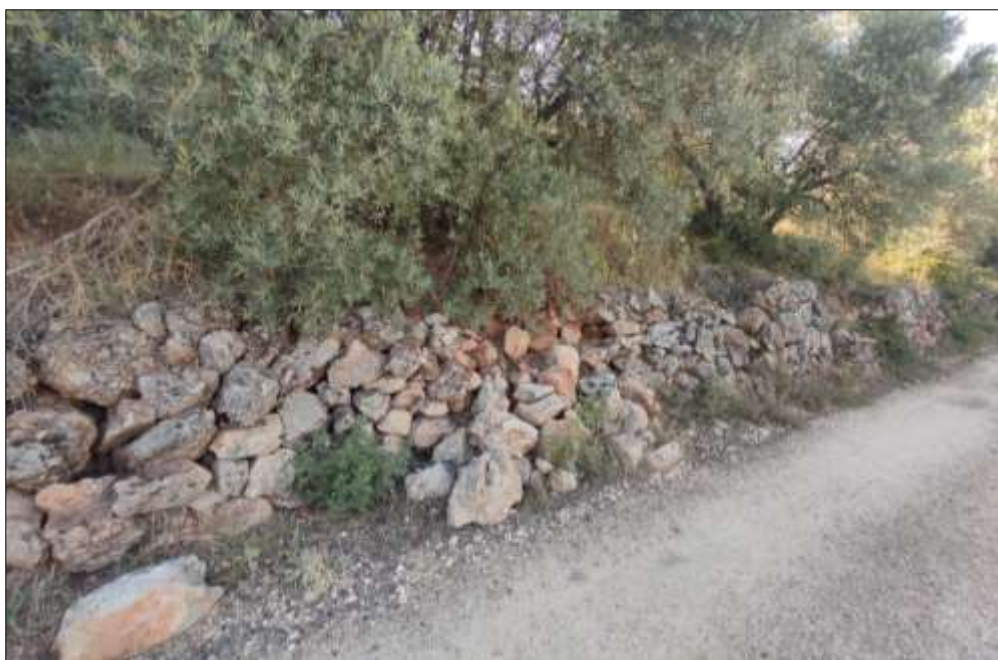
Fig. 26: Bancales deteriorados por el abandono de las actividades agrarias. Elaboración propia.
