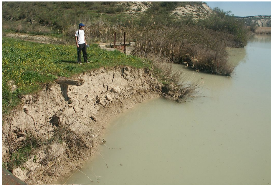
Figura 9. Escalón erosivo de considerable tamaño en el margen externo del meandro.
