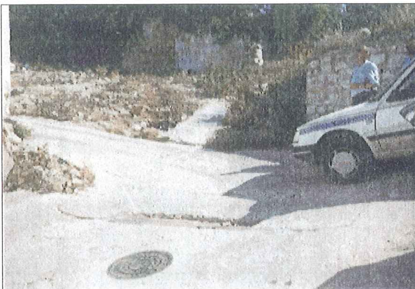
Foto 7.- Cañada de la C/ Agua. El agua, al no tener capacidad la red, discurre superficialmente por la calle.
