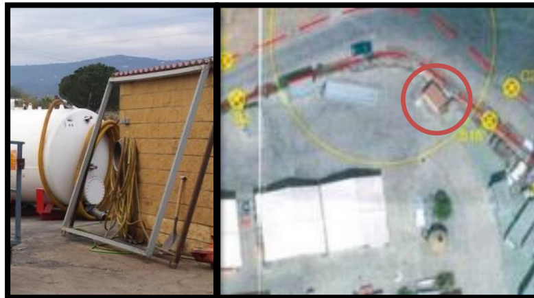
Figura 2.23: Depósito gasoil (Fuente: Autor)
