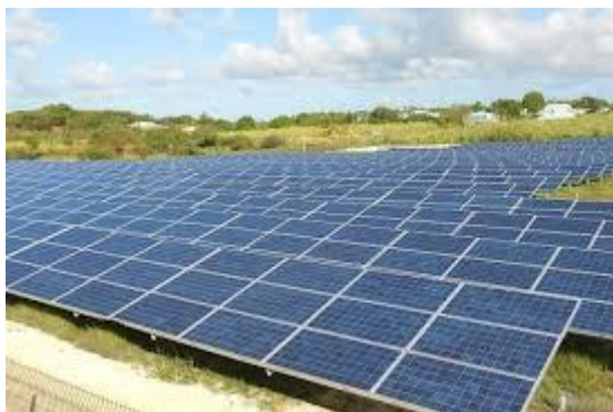
Ilustración 3. Estructura de sujeción de módulos fotovoltaicos.
