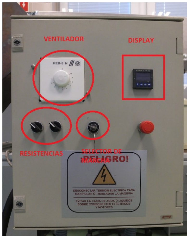
Ilustración 57: Cuadro eléctrico túnel de secado
