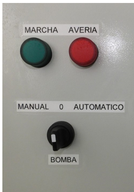
Ilustración 62: Posición Cero bomba
