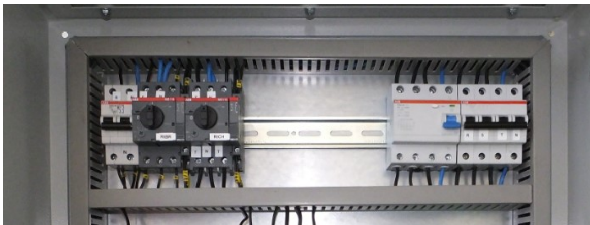
Ilustración 65: Interruptor general, MAG II y guardamotores bomba y chiller
