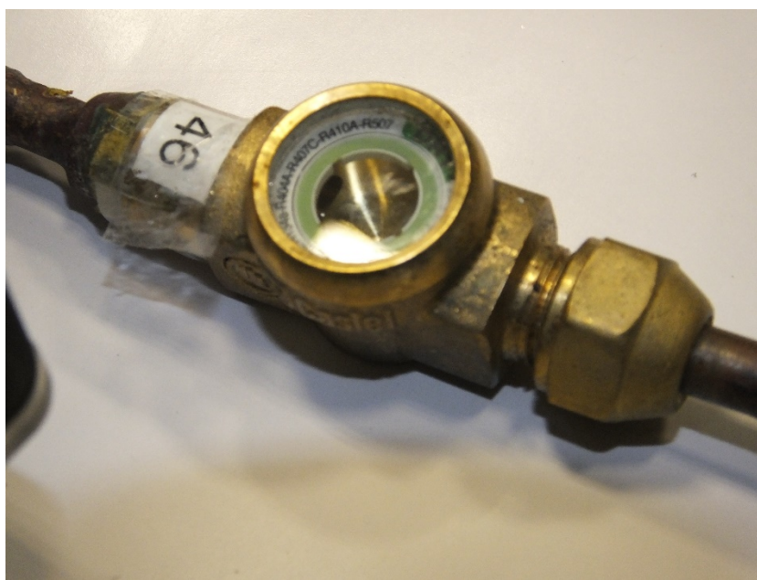
Ilustración 23: Visor líquido bomba refrigerante
