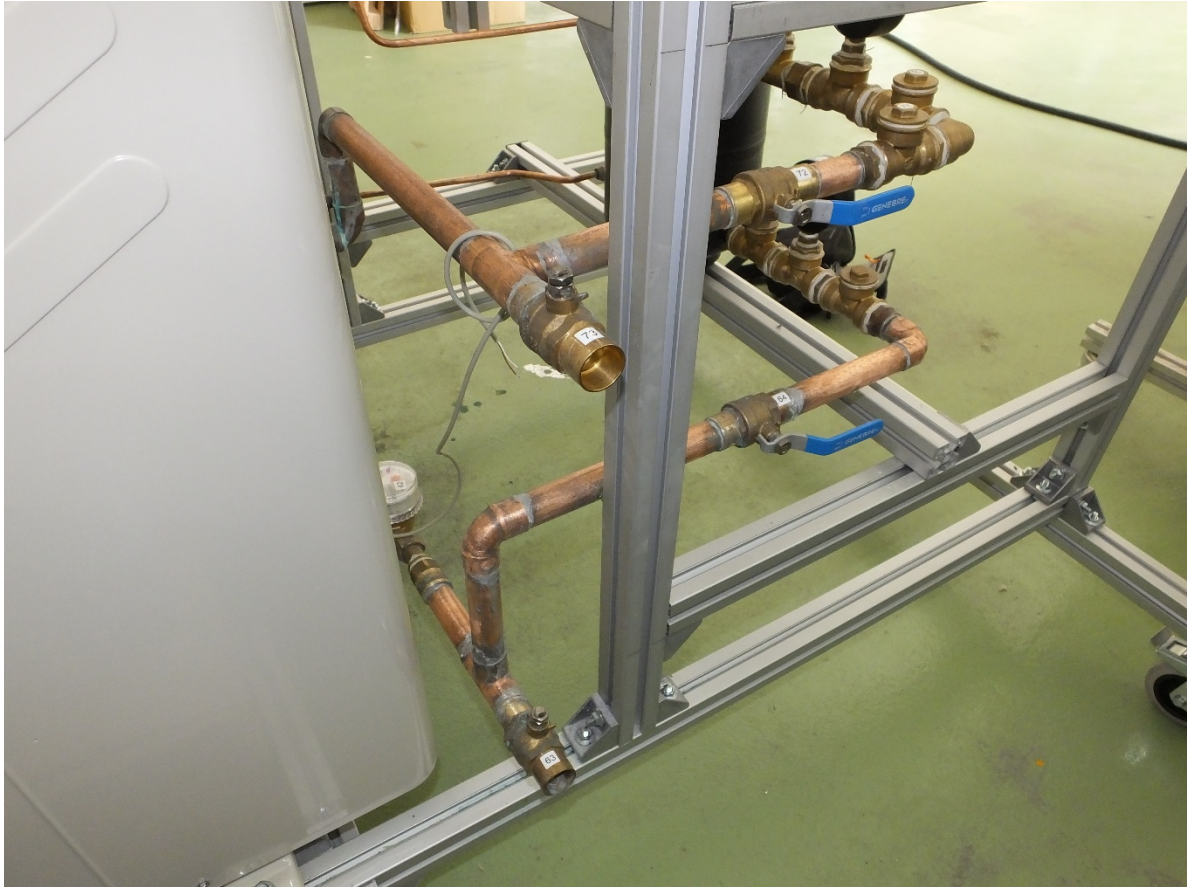
Ilustración 42: Localización válvulas 63, 73, 64 y 72
