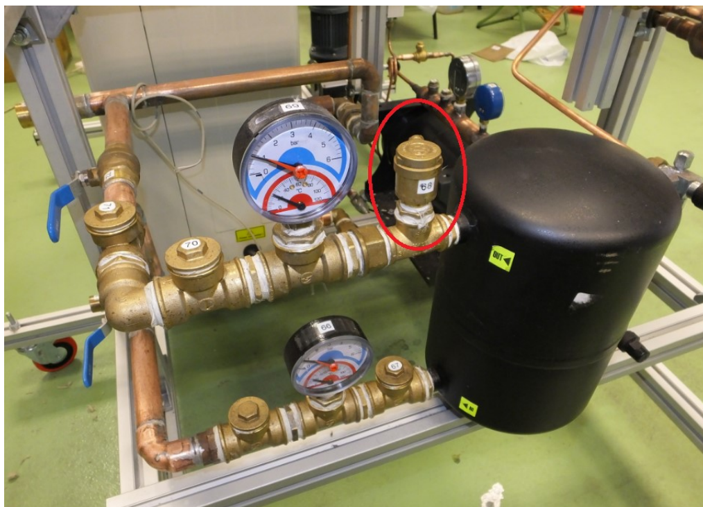
Ilustración 45: Localización purgador de aire
