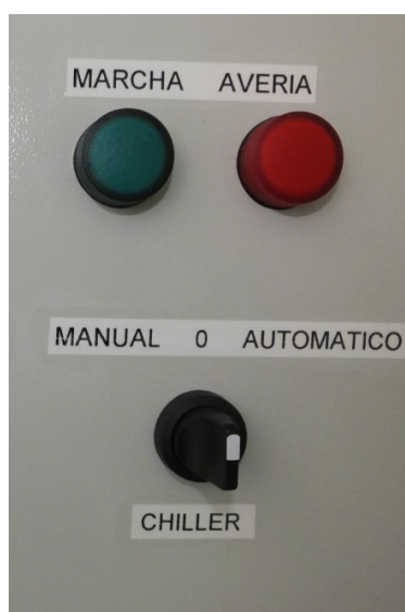
Ilustración 64: Posición Cero chiller
