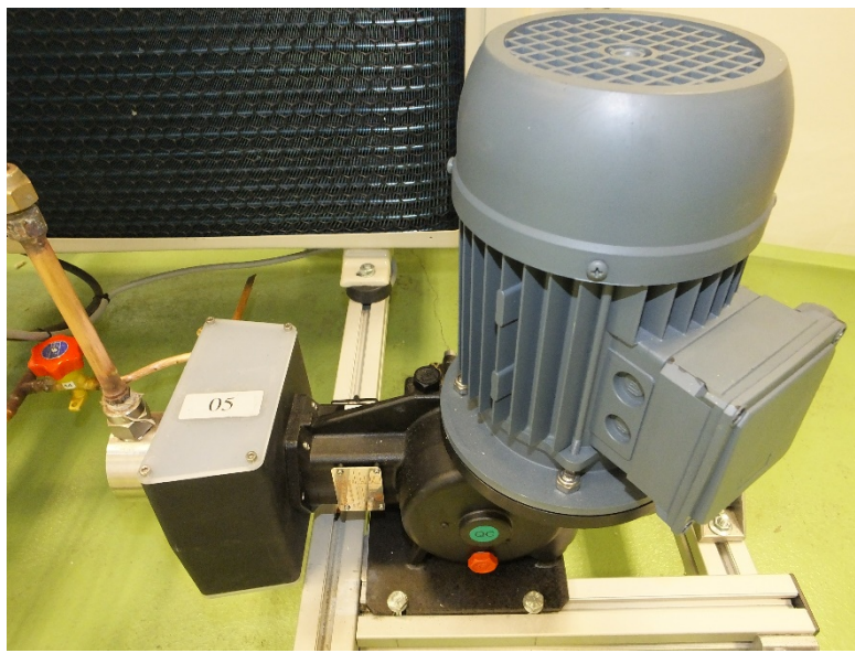
Ilustración 5: Bomba de refrigerante
