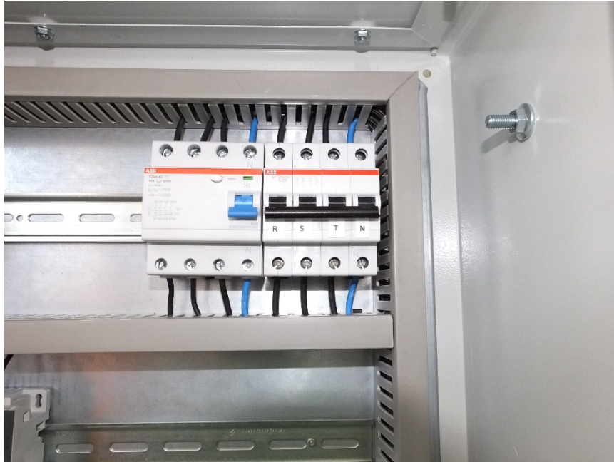
Ilustración 47: Interruptor general y diferencial
