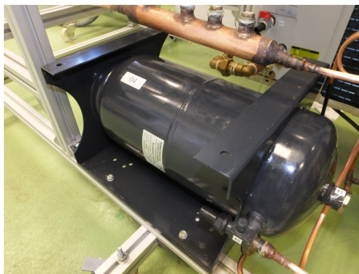
Ilustración 4: Depósito de refrigerante
