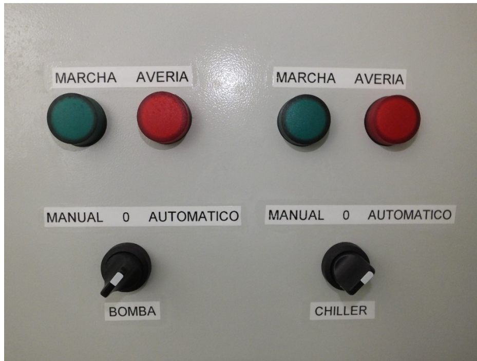
Ilustración 51: Posición automático para chiller y bomba
