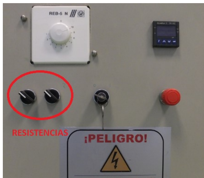
Ilustración 63: Resistencias Túnel de secado
