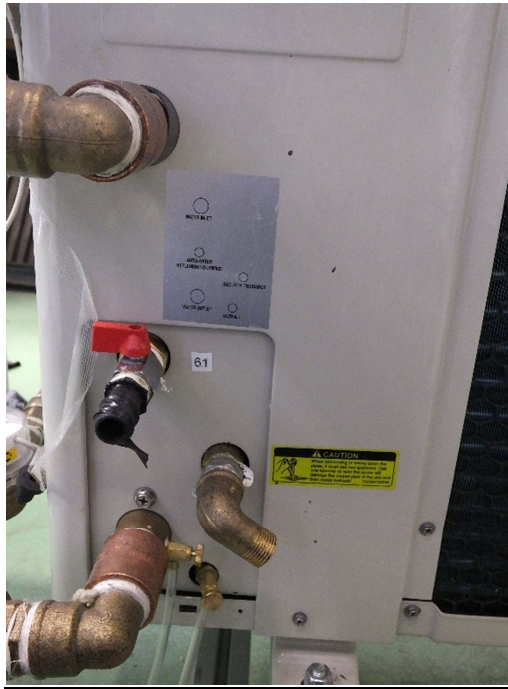
Ilustración 27: Válvula mariposa carga/desagüe chiller
