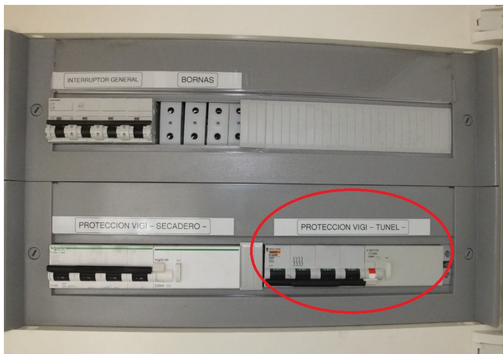
Ilustración 56: Cuadro eléctrico túnel de secado
