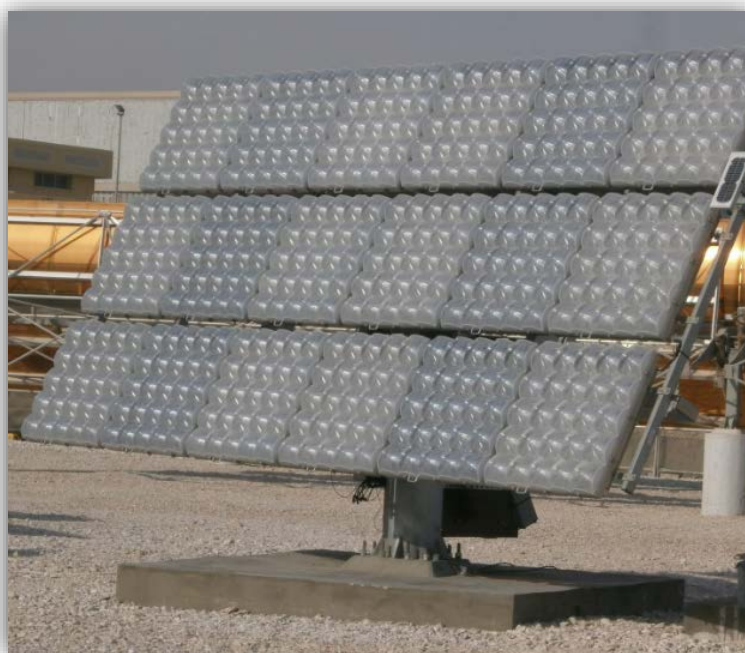
Fotografía 4.1. Tracker o seguidor solar. Fuente [6]
