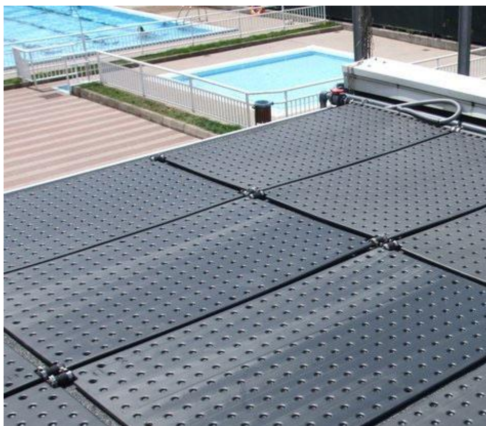
Fig. 4-95 Ejemplo instalación solar en piscina pública
