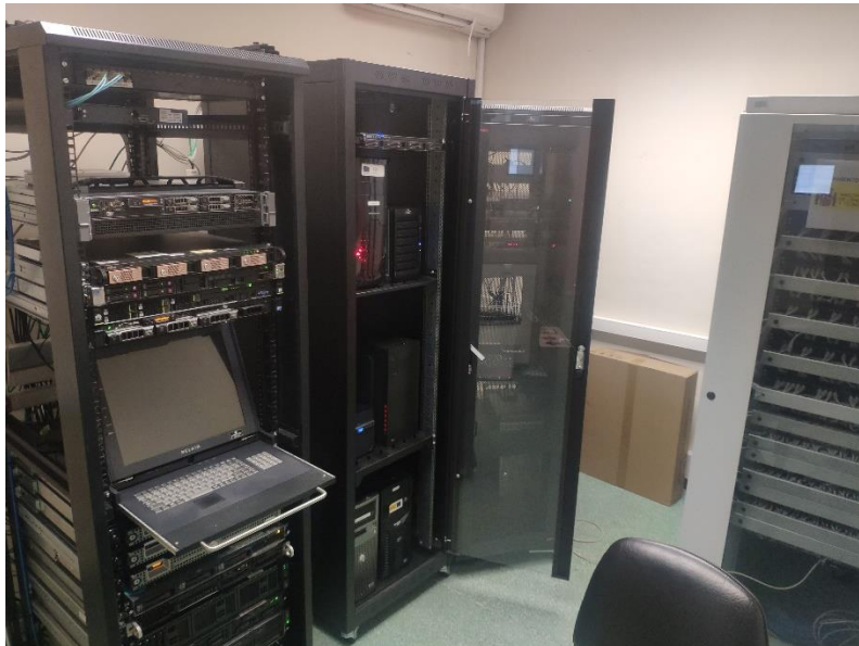
Ilustración 1.16. Sala de servidores del Departamento (A3-185)
