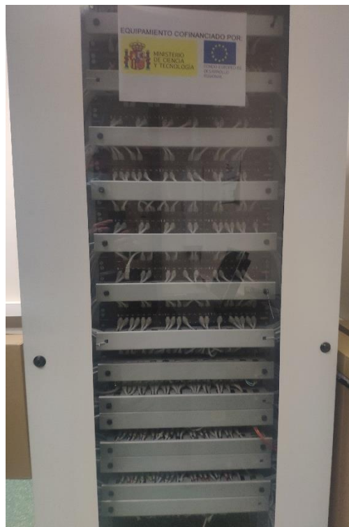
Ilustración 1.14. Armario (o rack) de comunicaciones de la sala de servidores
