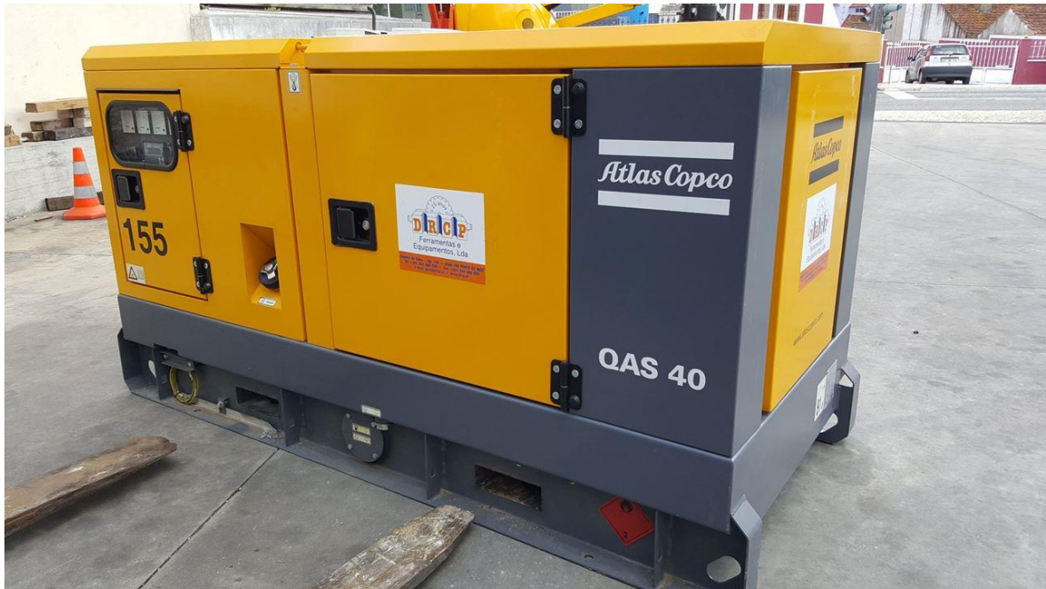
Imagen 29 – Generador eléctrico Atlas Copco QAS 40
