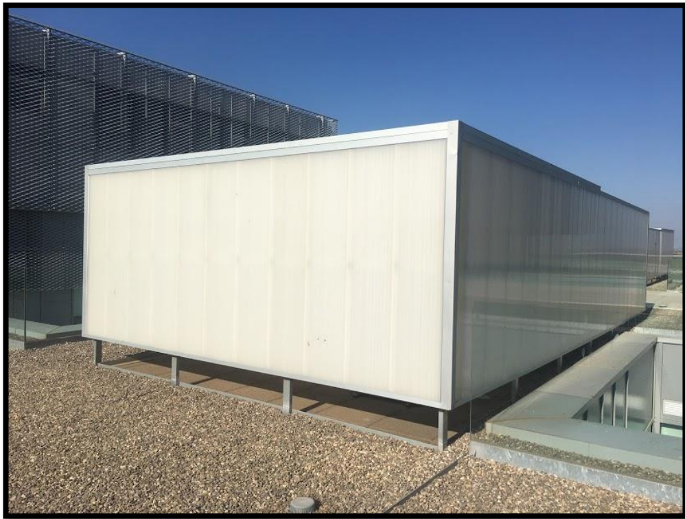
Figura 4.8. Instalaciones dentro de la cubierta.
