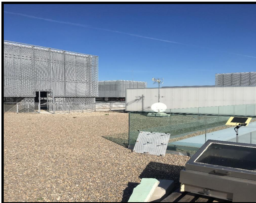
Figura 4.3. Grava e instalaciones de aire acondicionado.
