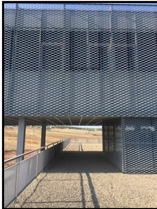
Figura 4.9. Estrechamiento del ancho de la cubierta.
