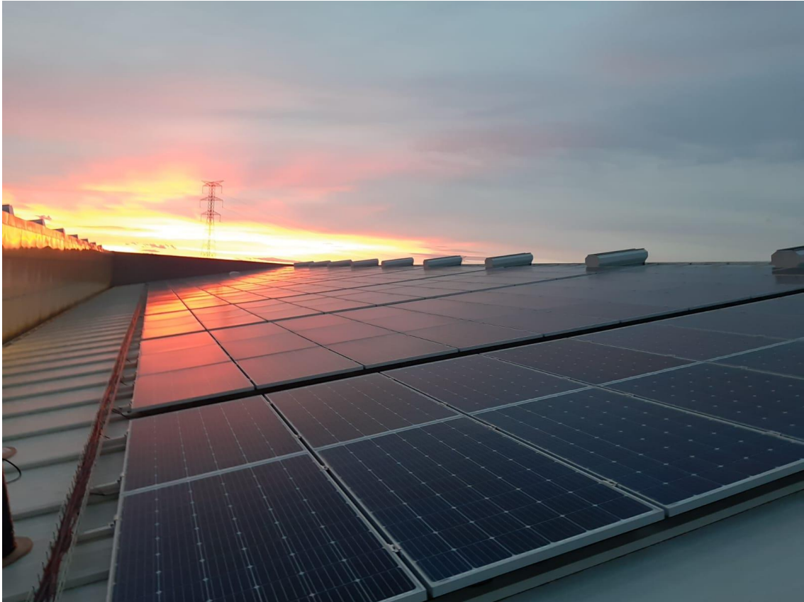
Figura 2. Placas fotovoltaicas instaladas en la Universidad de Málaga (Fuente propia)
