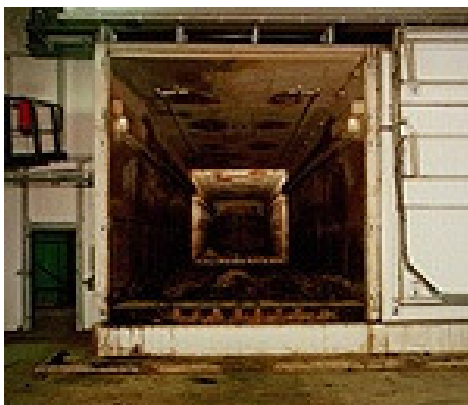
Figura 2.16: Fotografía de túnel de compostaje
