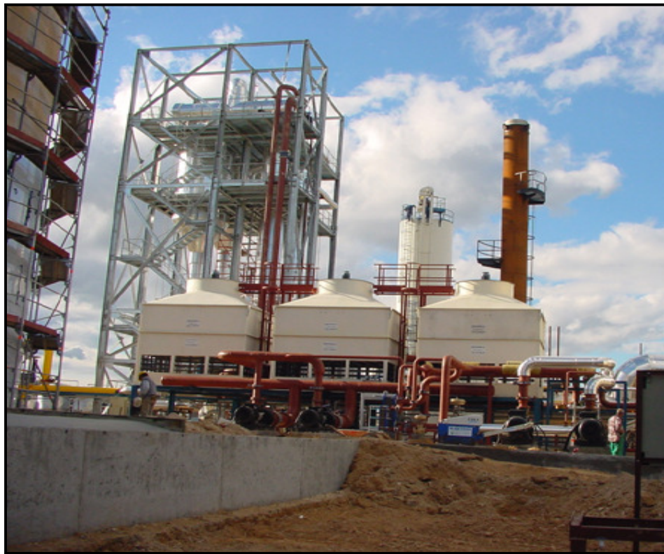
Figura 2.5: Planta para la eliminación de purines de cerdo, transformándolos en abono y generando electricidad.
