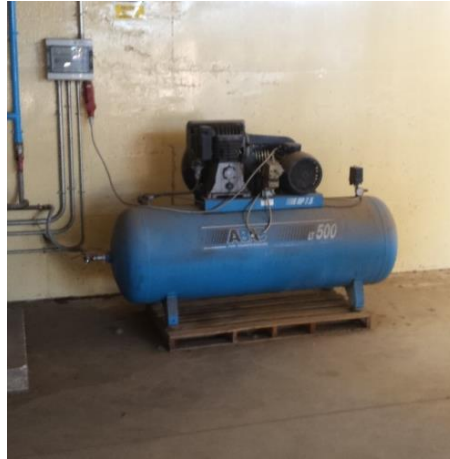
Ilustración 25. Equipo compresor I.
