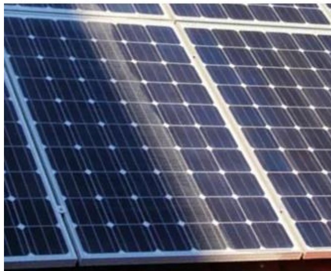
Figura 8: Módulo fotovoltaico sombreado longitudinalmente
