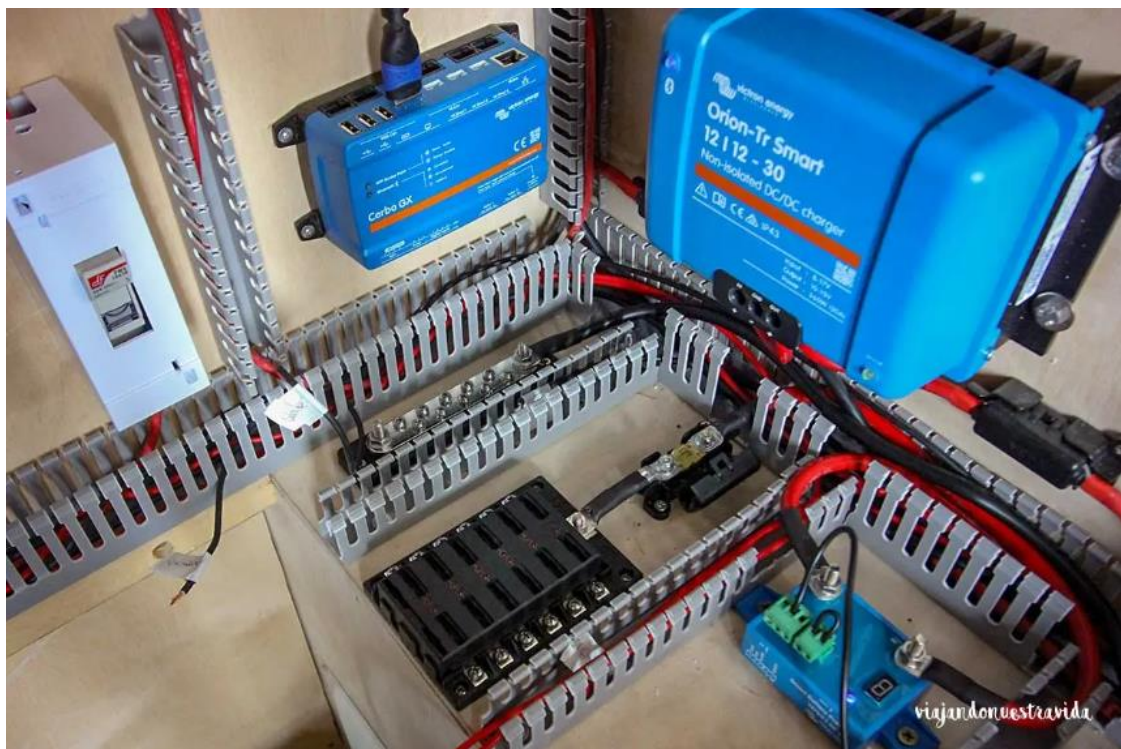
Figura 12. Instalación eléctrica camper a 12V
