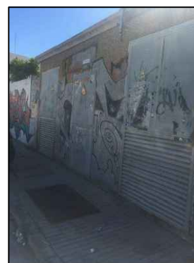
TRANSFORMADOR POR CALLE ALBAÑILERIA
