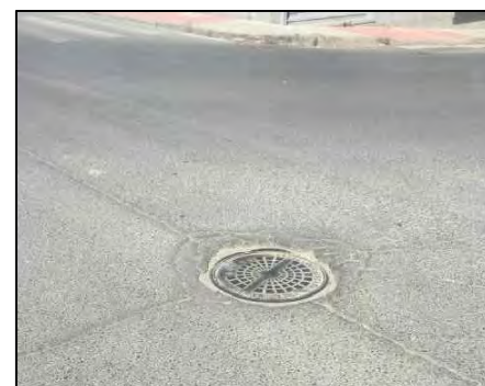
ARQUETA DE SANEAMIENTO POR CALLE ARTESANIA
