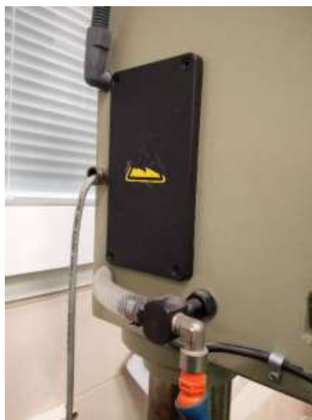
Imagen 25 Tapa de contactores.
