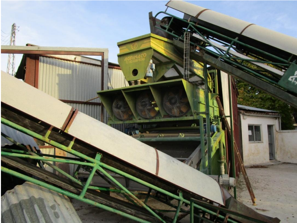
ILUSTRACIÓN 11. DETALLE LINEA DE SOPLADO
