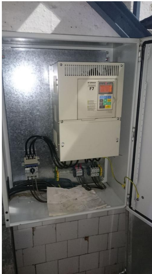
ILUSTRACIÓN 17. DETALLE VARIADOR DE FRECUENCIA DECANTER
