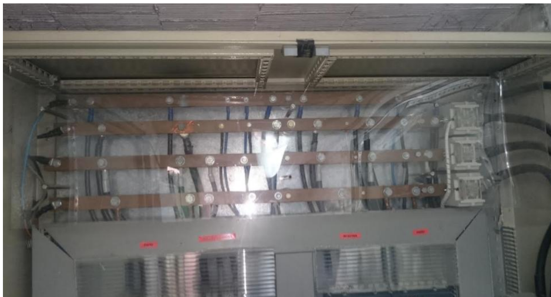
Ilustración 31. detalle conexión suministros al embarrado
