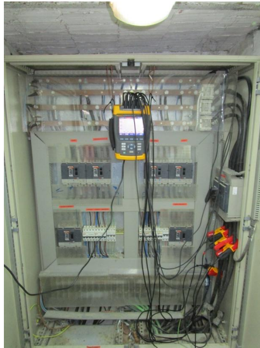
ILUSTRACIÓN 3. CONEXIÓN ANALIZADOR EN CUADRO GENERAL
