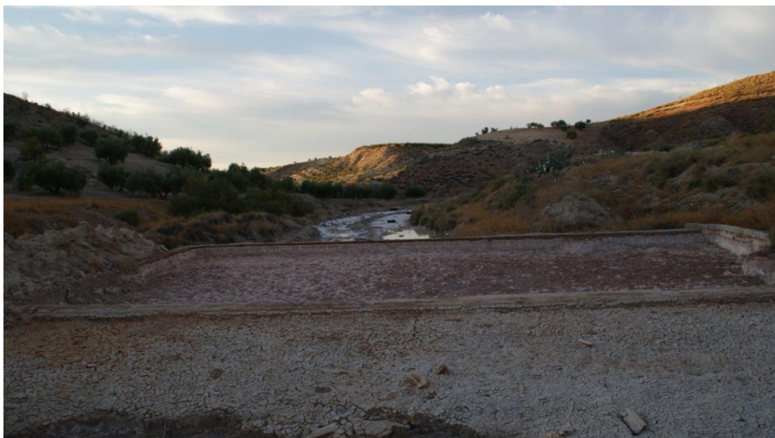
Fig.37: Arriba, vista de la alberca de la salina oriental. Abajo, detalle de la sal acumulada en que recubre el muro de la alberca (Foto: Autor).
