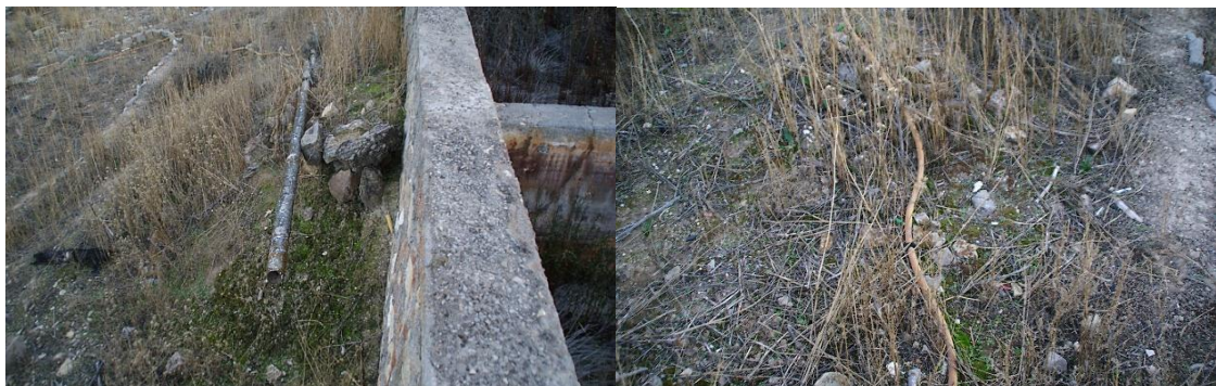
Fig.34: Ejemplos del sistema de canalizaciones mediante tuberías de plomo y mangueras de plástico (Fotos: Autor).
