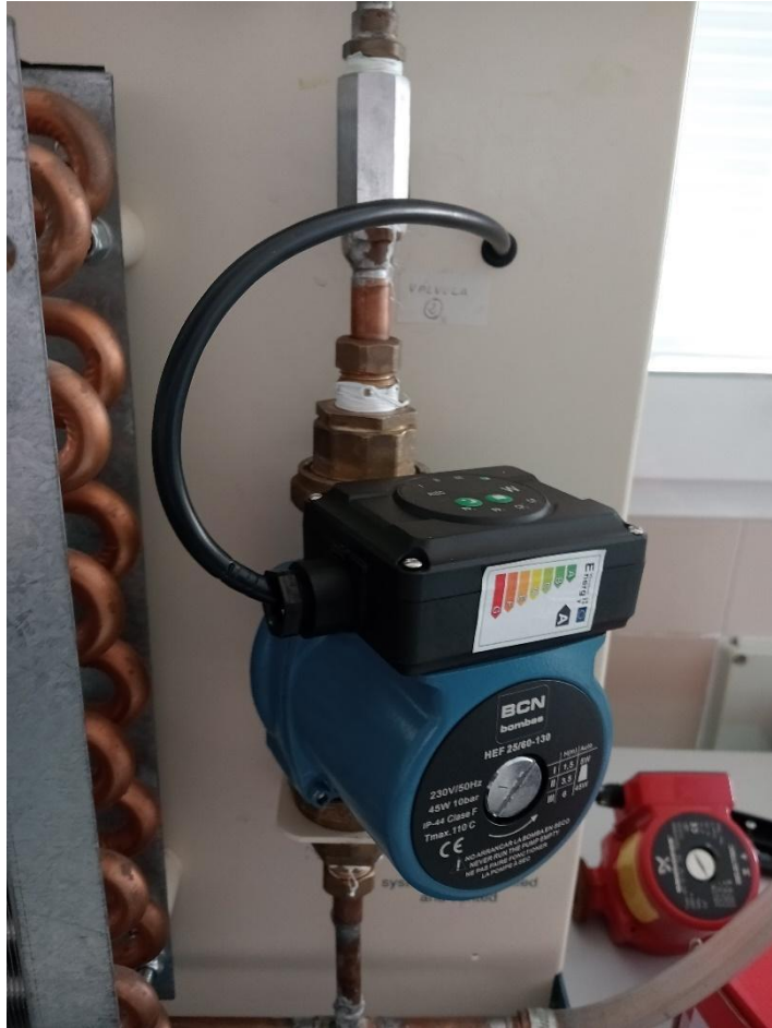
Figura 6 : Bomba de agua del circuito secundario.
