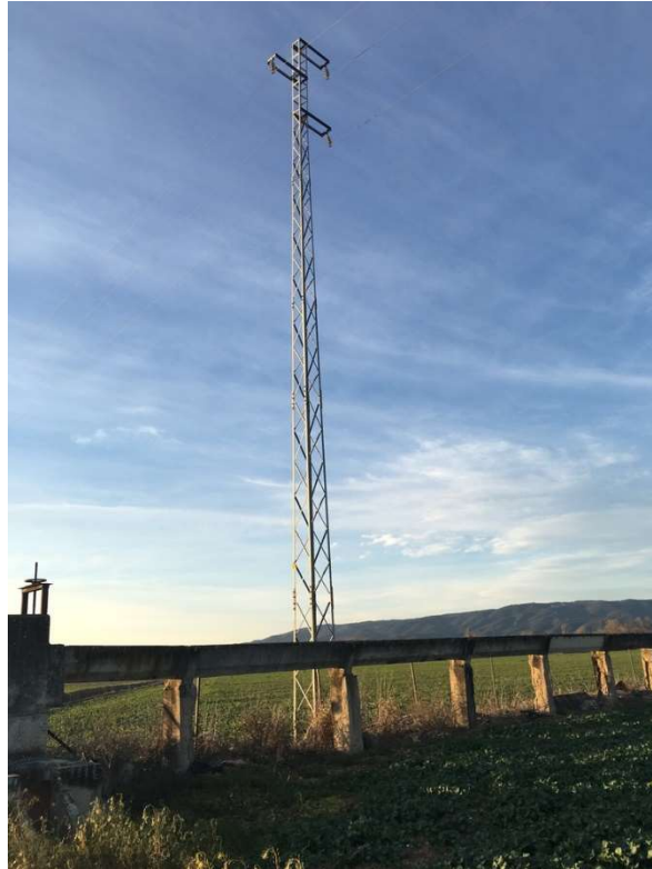
Figura 27.1: Torres de Alta Tensión del margen norte de la Autovía A-4 / Reportaje Fotográfico Propio
