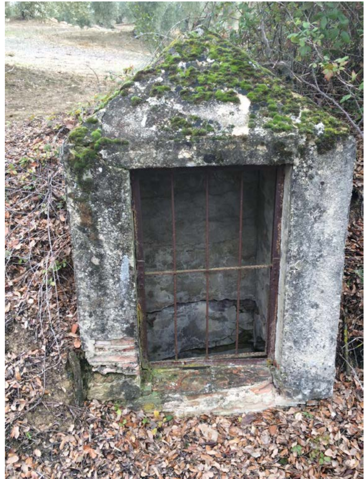
Ilustración 25B. Chimenea para acceso de mantenimiento del canal
