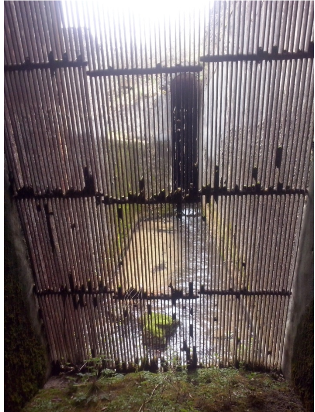
Ilustración 35B. Rejilla acceso cámara de carga
