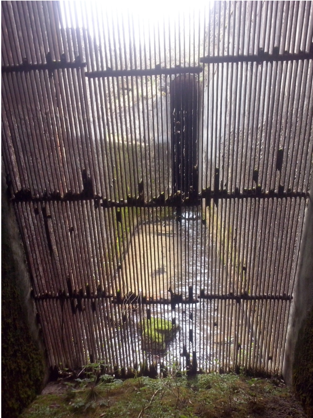
Ilustración 47. Rejilla de la cámara de carga
