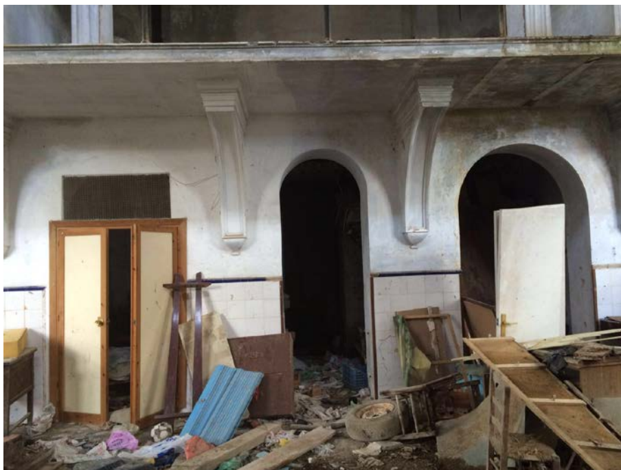
Ilustración 11. Sala de transformadores y servicios
