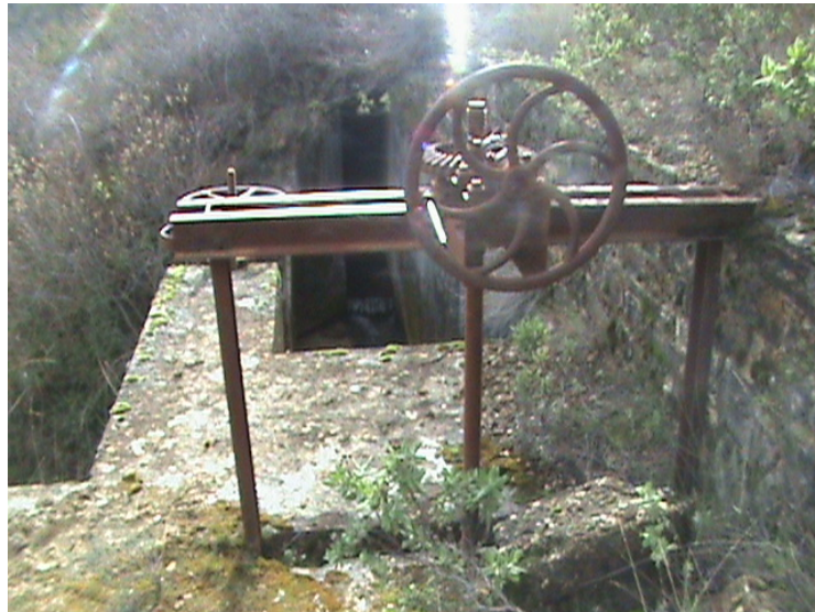
Ilustración 44. Mecanismo de compuerta de entrada a cámara de carga
