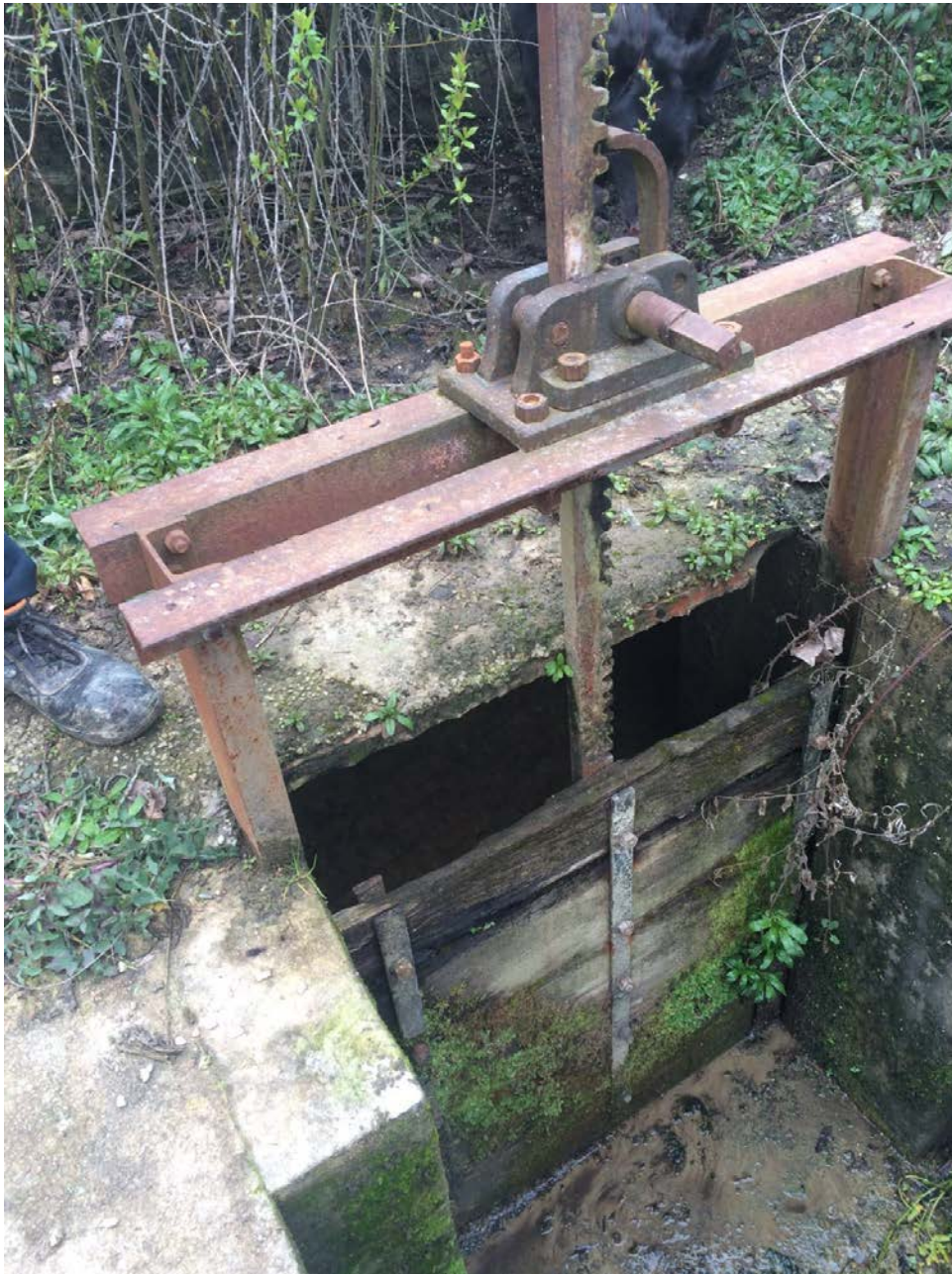
Ilustración 42. Compuerta de vaciado del canal
