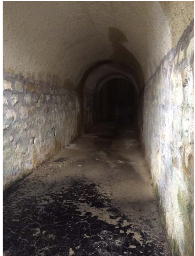
Ilustración 51B. Túnel hacia foso de turbinas
