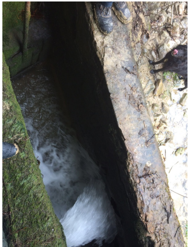
Ilustración 53B. Inicio del canal para transporte de agua potable
