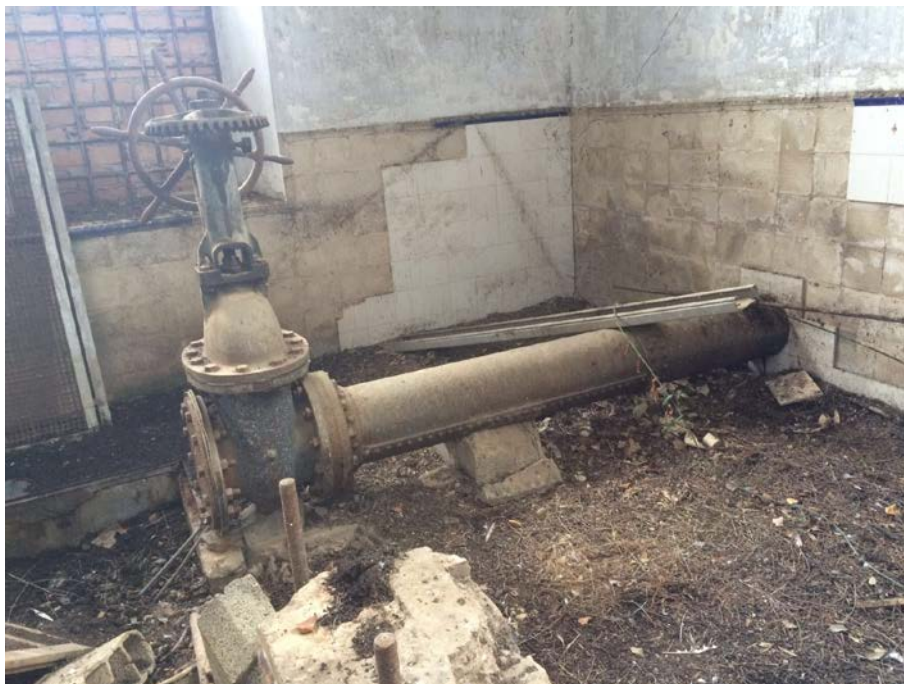
Ilustración 13. Final de tubería de presión
