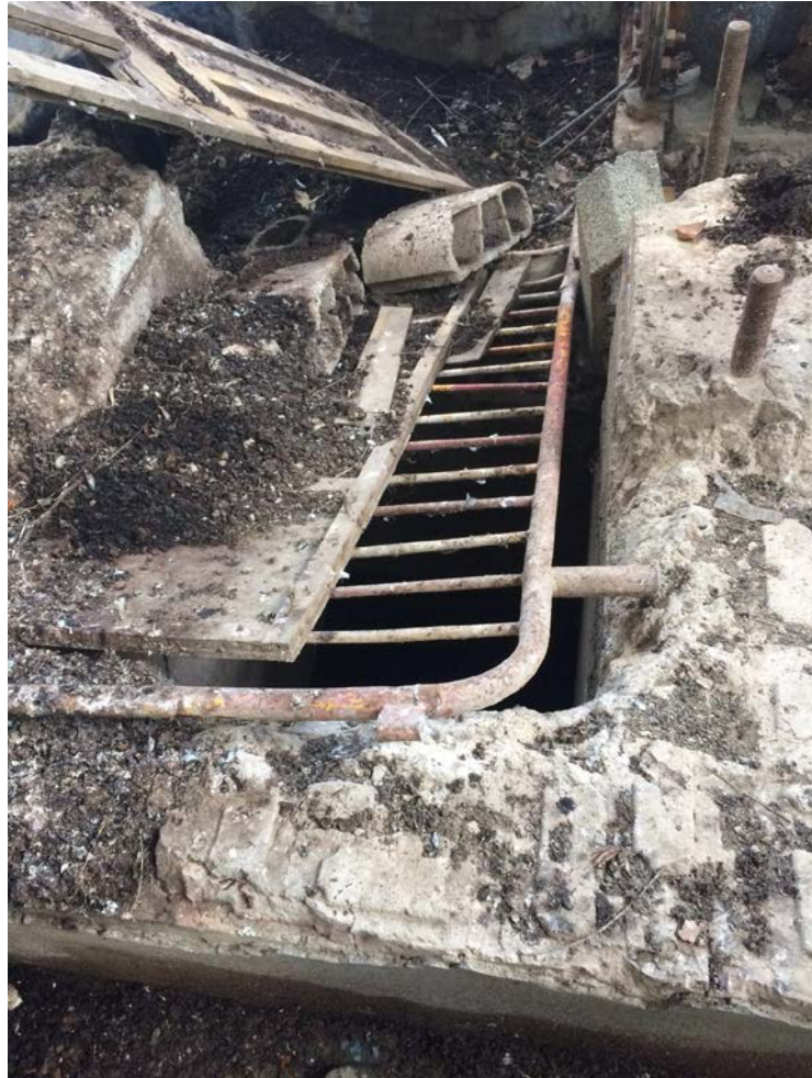
Ilustración 14. Desagüe de turbina
