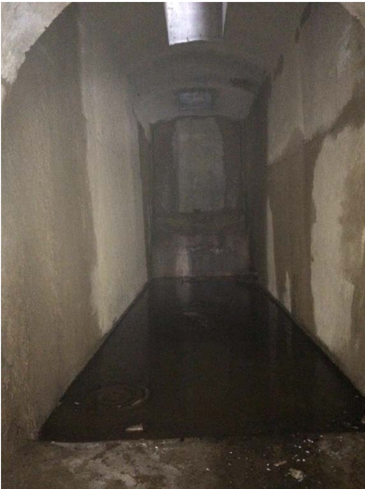
Ilustración 51A. Foso de turbinas, salida de las dos turbinas
