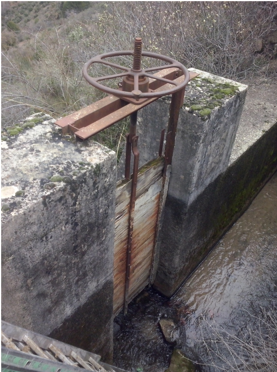
Ilustración 43. Compuerta de canal de desagüe
