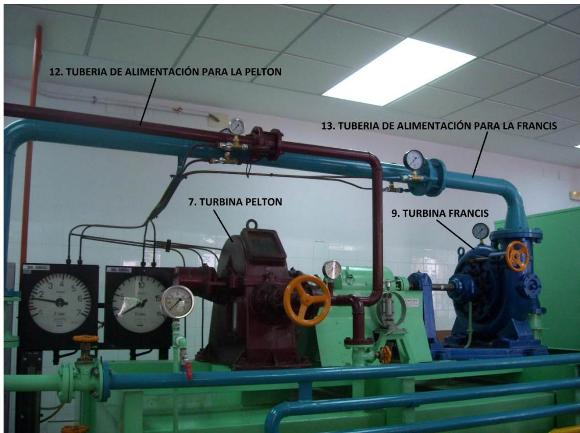
Figura 10. 5. Tuberías de alimentación para la turbina Pelton y Francis y ambas turbinas.
