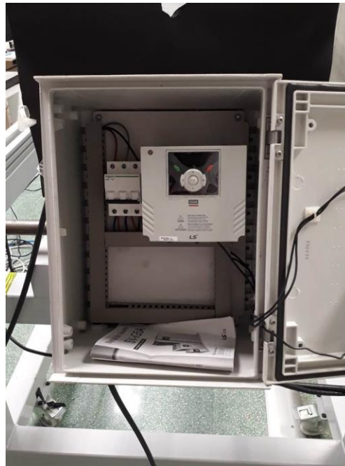
Figura 21. Variador de frecuencia.
