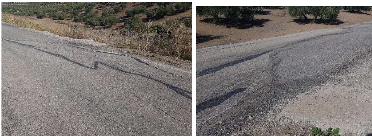
Ilustración 1. Firme agotado estructuralmente.
